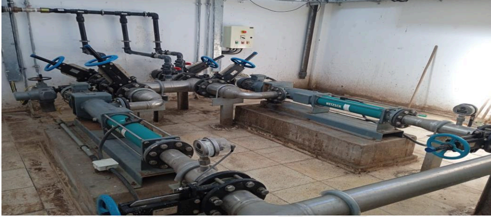
Şekil 3.6. Ön çamur pompa istasyonu
