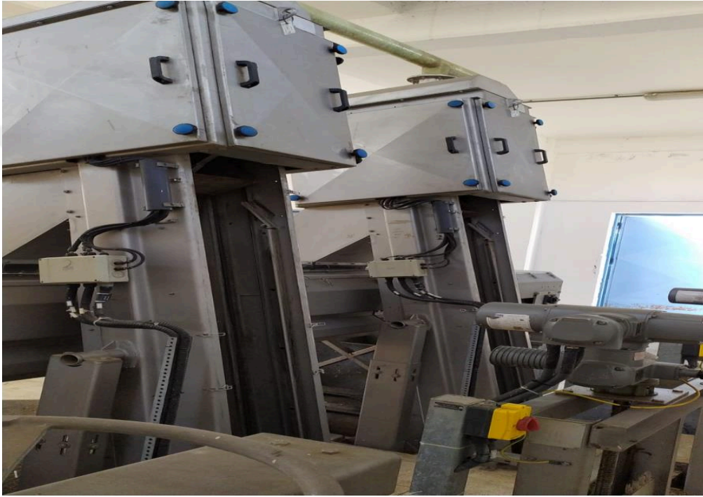
Şekil 3.2. Kaba ızgara ünitesi
