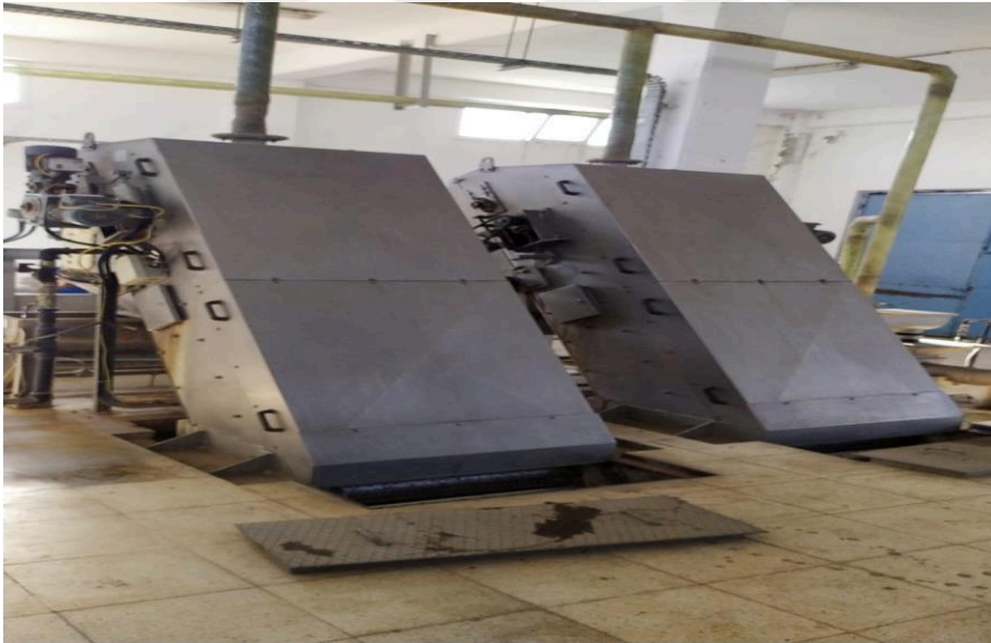
Şekil 3.3. İnce ızgara ünitesi
