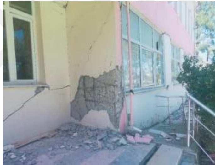
Şekil 2.13. Kısa kolon kullanımı sonucu hasar, Kahramanmaraş (AFAD, 2023).
