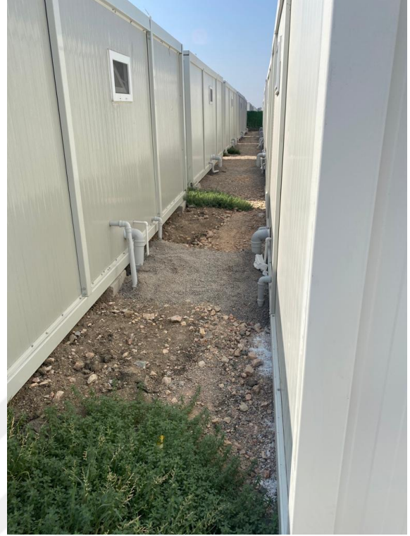
Şekil 3.10. Konteynerlerin altyapı bağlantısı (AFAD röportajı, 2023).
