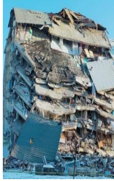
Şekil 2.8. Zemin katı ticarethane olarak kullanılan, yumuşak kat kaynaklı hasar, Malatya (AFAD, 2023).
