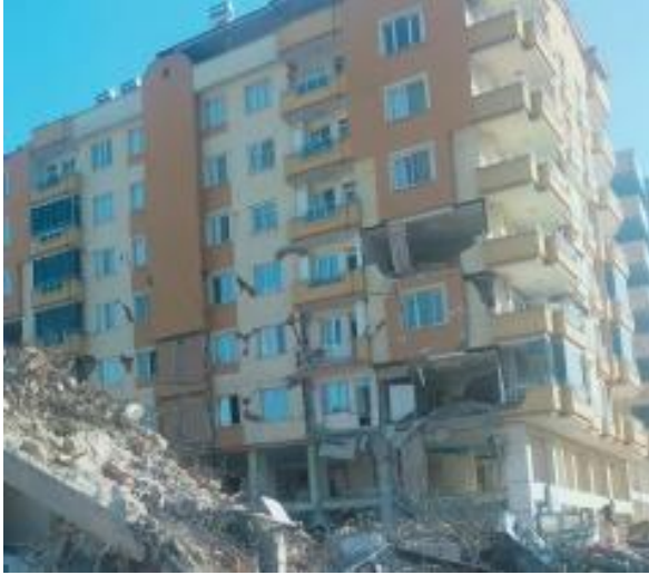
Şekil 2.11. Dolgu duvar kaynaklı hasar, Gaziantep (AFAD, 2023).
