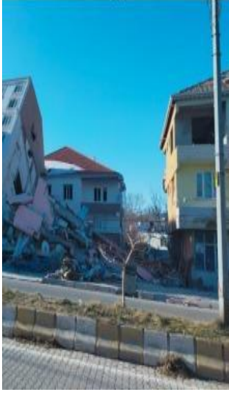
Şekil 2.7. Zemin kaynaklı hasar, Adıyaman (AFAD, 2023).
