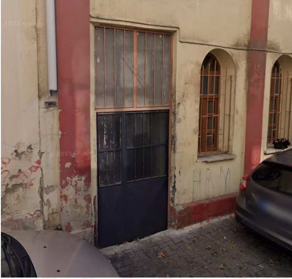
Şekil A.102: Batı cephede sonradan açılan demir kapı (Google Maps).
