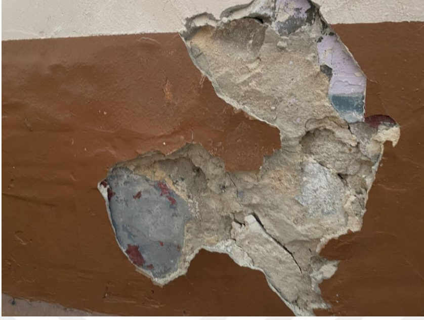
Şekil A.110: Duvarda sıva ve boya dökülmesi ve moloz taş örneği.
