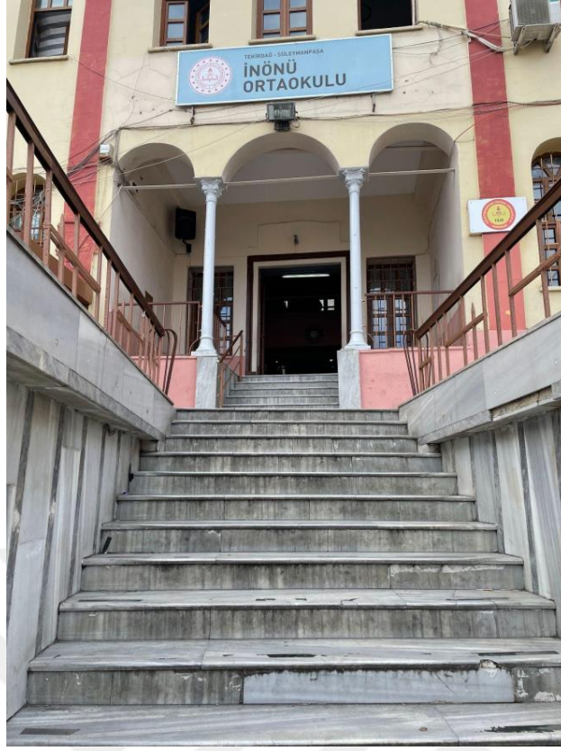
Şekil A.118: Bahçeden girişin sağlandığı merdivenlerde asansör eksikliği.
