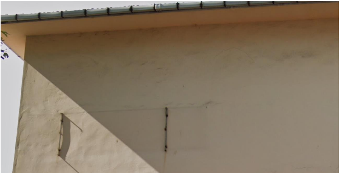
Şekil A.99: Kuzey cephede kapatılan pencerelerin izleri.
