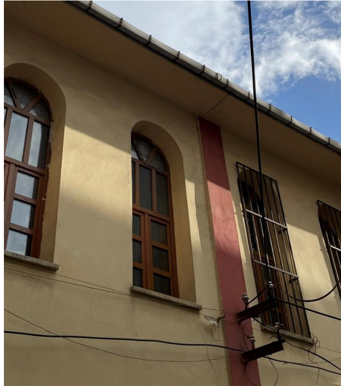
Şekil A.117: Çatıyı taşıyan döşemede strüktürel çatlak.
