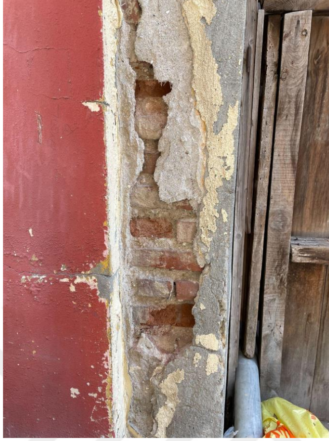
Şekil A.114: Batı cephe duvarında sıva dökülmesi ve tuğla örgü örneği.
