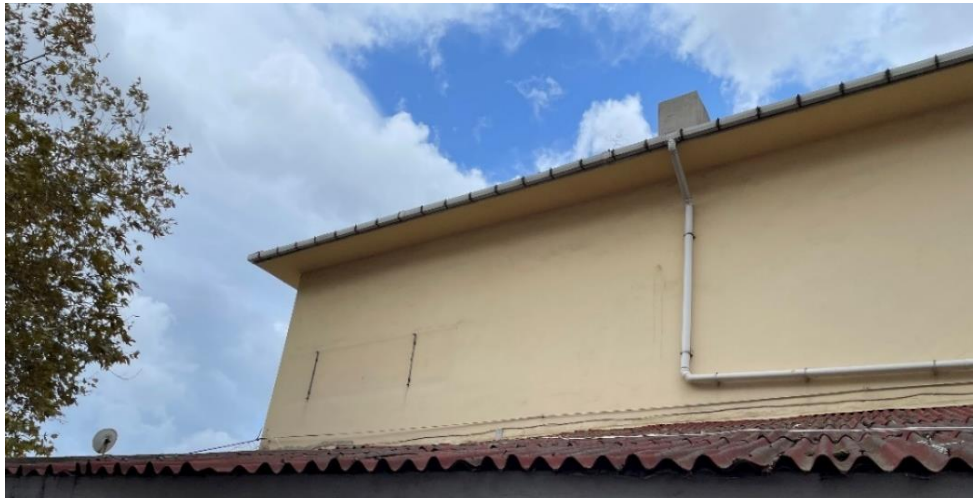
Şekil A.67: Kuzey Cephe kapatılmış pencere izleri.
