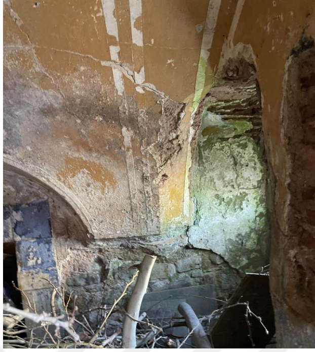
Şekil A.112: Mahzen bölümünde sıva ve boya dökülmesi.
