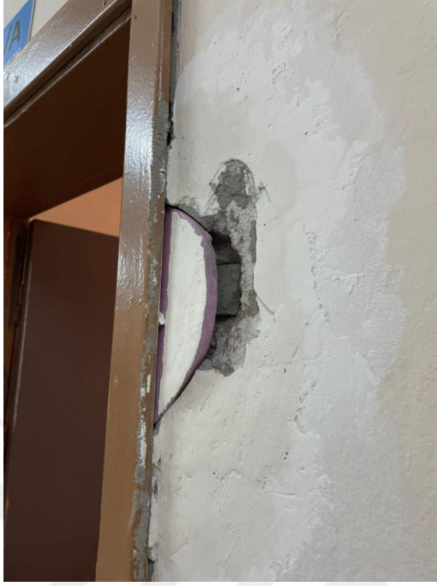
Şekil A.106: Parça kopması ve sıva dökülmesi örneği.
