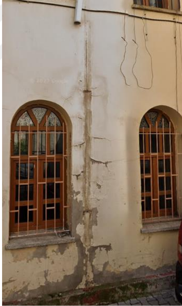
Şekil A.113: Batı cephesi rutubet kaynaklı kabarma ve sıva dökülmesi.
