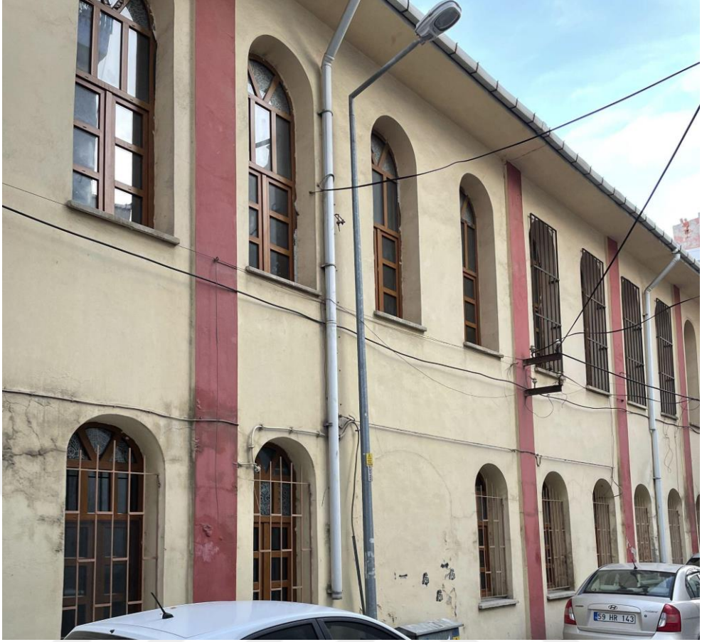
Şekil A.68: Batı cephesi ve kapatılan kapının izleri.
