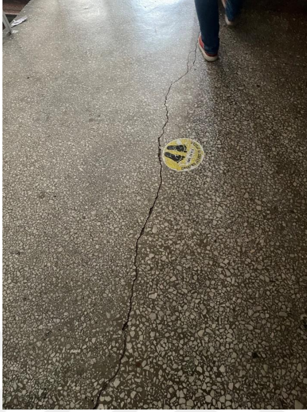
Şekil A.108: Zeminde kılcal çatlak örneği.
