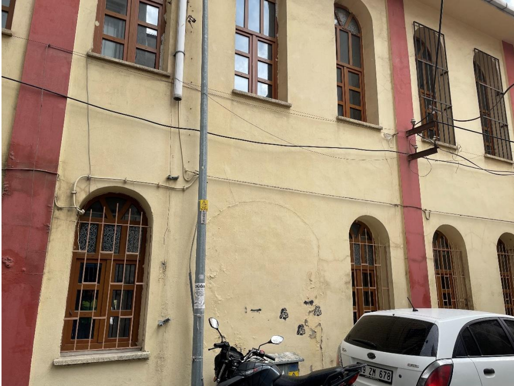
Şekil A.103: Batı cephede kapatılmış kapının izleri.
