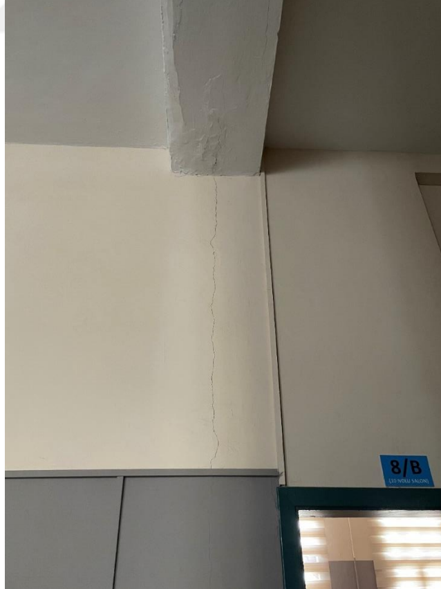
Şekil A.109: Duvarda kılcal çatlak örneği.
