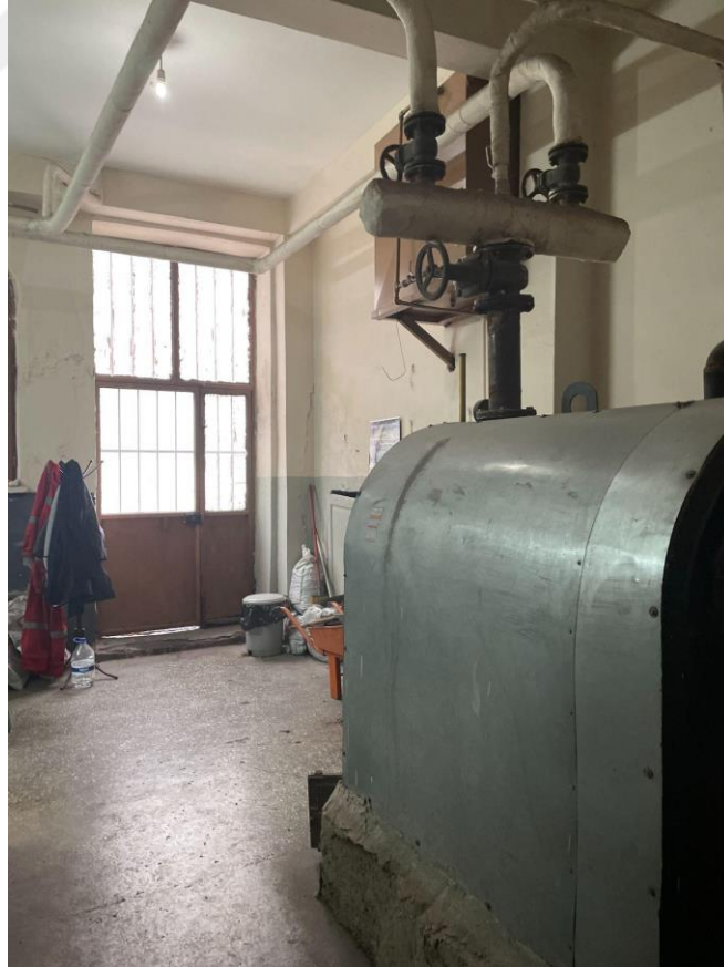
Şekil A.119: Kazan dairesinde kömür kazanı.
