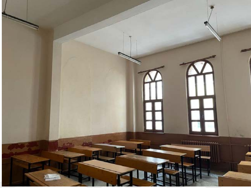
Şekil A.100: Güney cephede kapatılan pencerelerin izleri.
