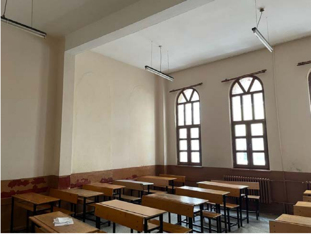
Şekil A.34: K-107 Sınıfı ve güney cephe pencere izleri.
