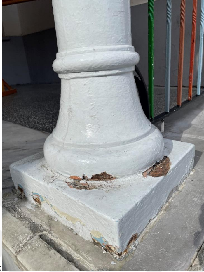
Şekil A.116: Dökme demir kolonlarda korozyon.
