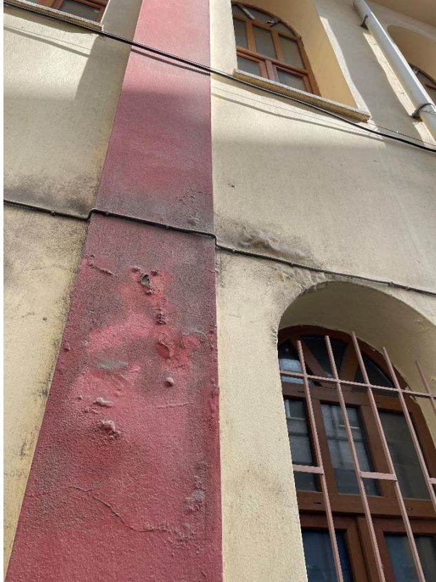
Şekil A.115: Batı cephede rutubet kaynaklı kabarmalar.
