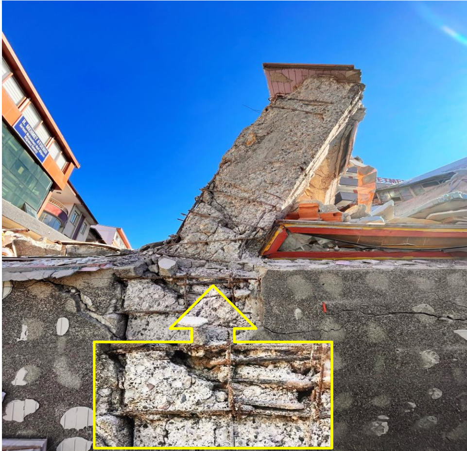
Şekil 1.16 : Hasarlı betonarme yapılarda gözlenen donatı korozyonları (Kumbasaroğlu ve diğ, 2023).
