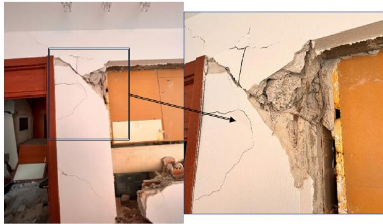
Şekil 1.30 : Betonarme kolon kesme hasarı.
