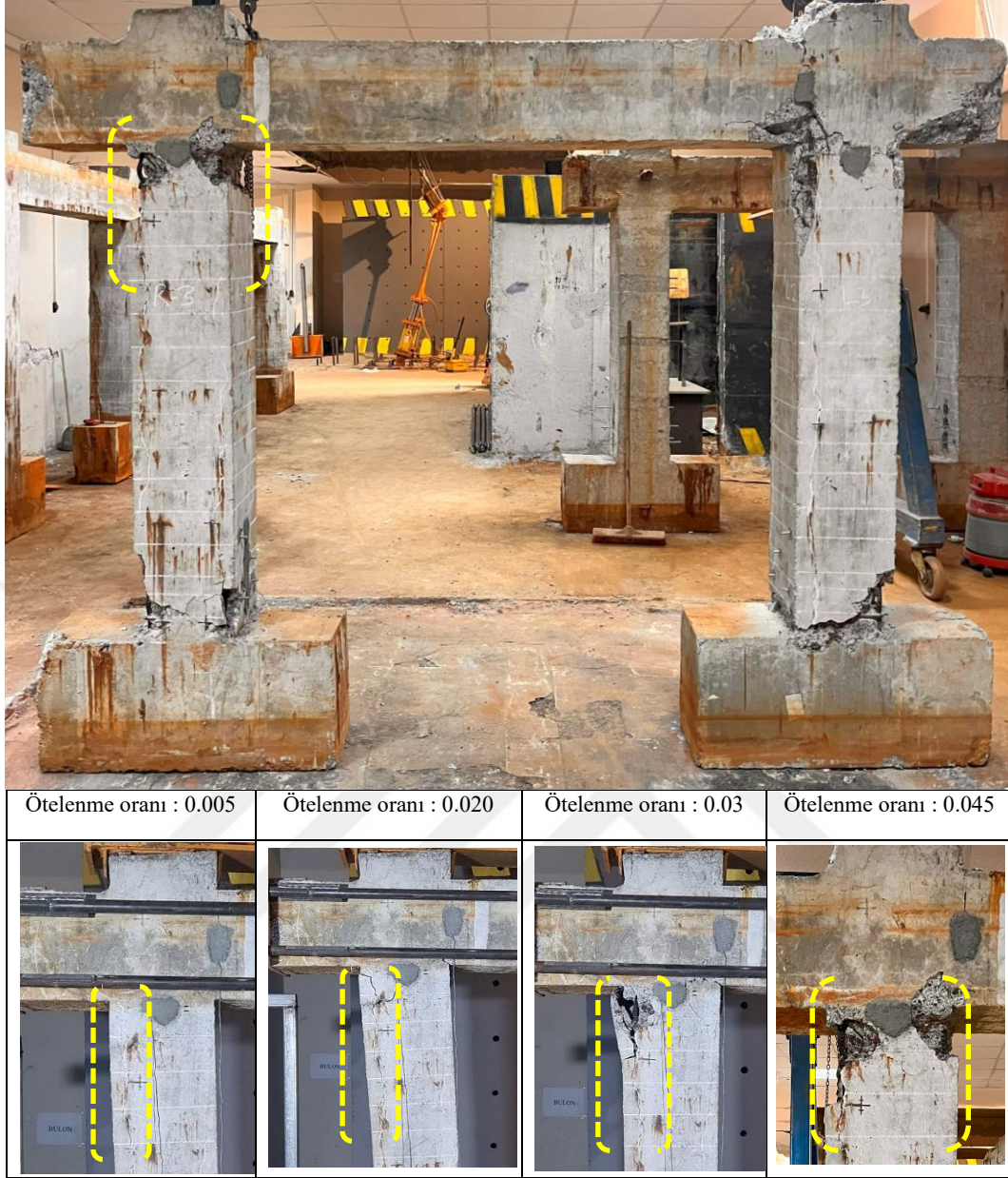
Şekil 4.36 : RCF 2 çerçevesi hasar durumu.
