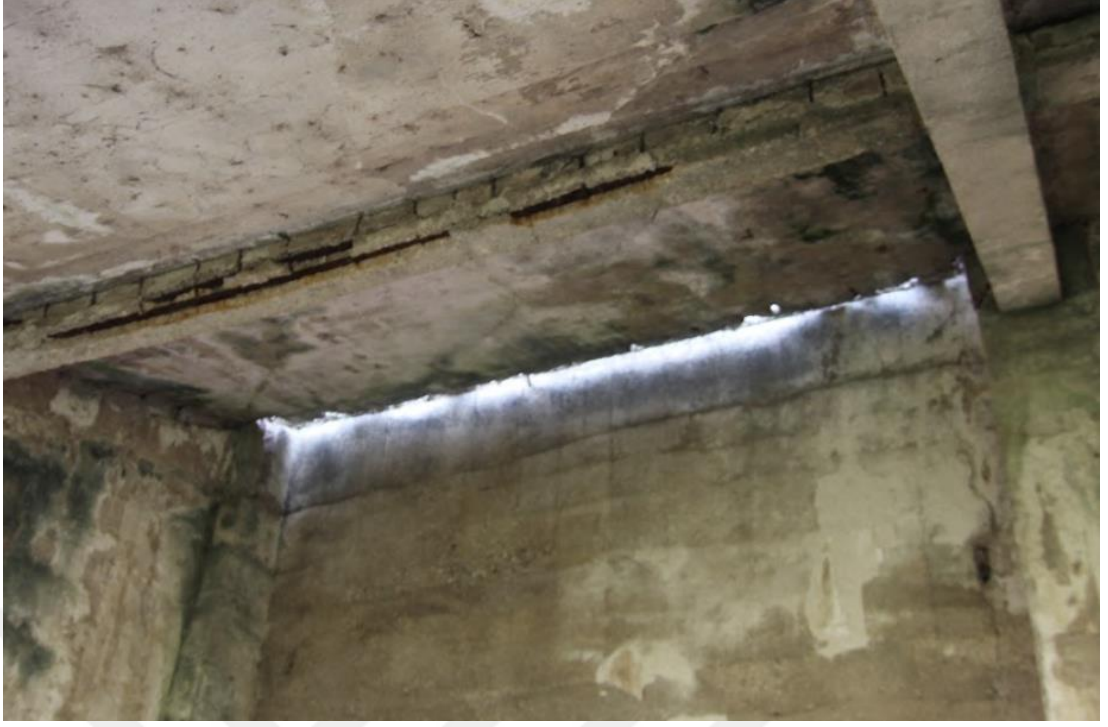
Şekil D.49: Kuzey sahında çatı-duvar birleşim noktasında malzeme kaybı.
