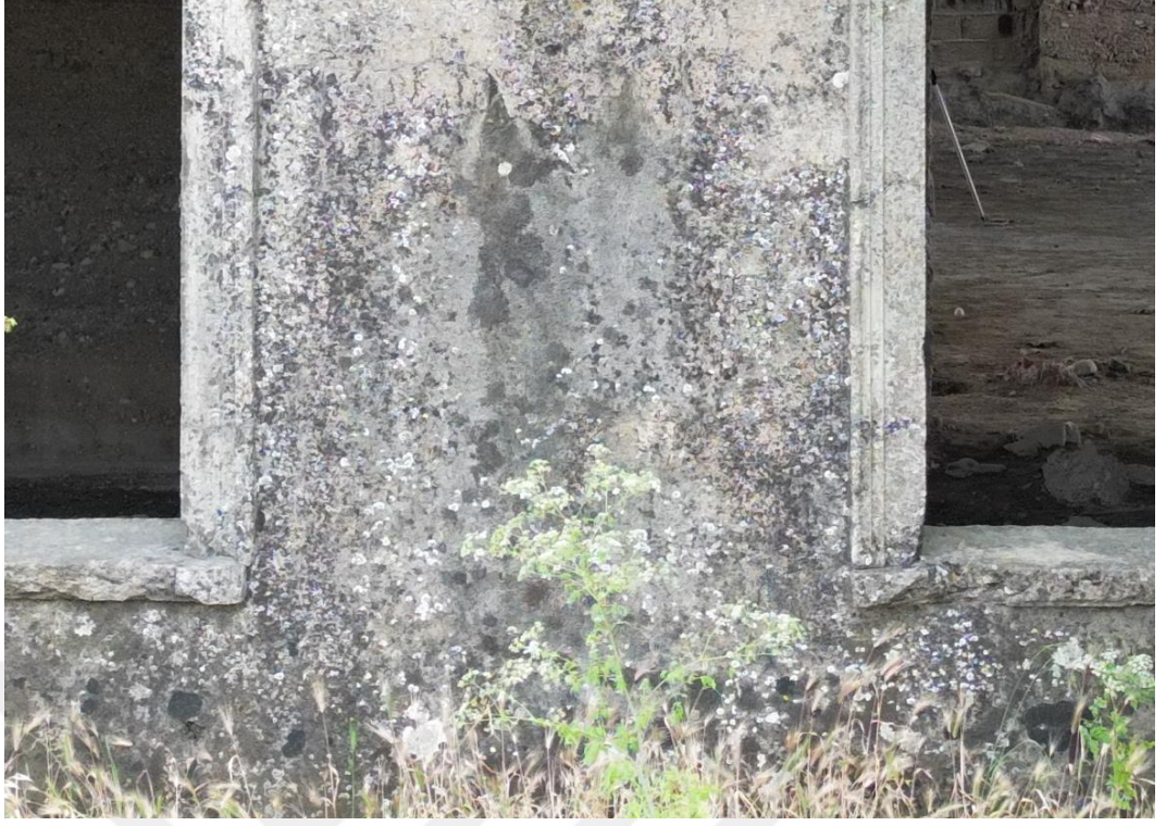
Şekil D.54: Kuzeybatı cephede liken oluşumu.
