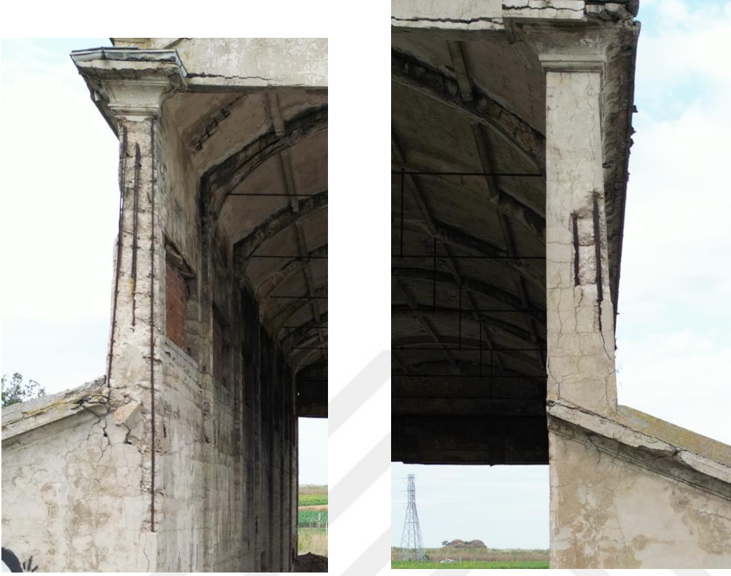
Şekil 3.27 Güneybatı cephesinde pas payı dökülmeleri ve strüktürel çatlaklar.
