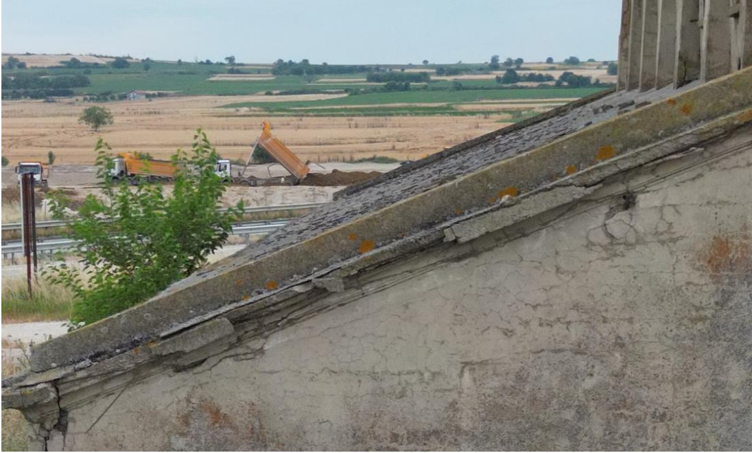
Şekil D.48: Kuzeydoğu cephede bulunan çatı saçığında malzeme kaybı.
