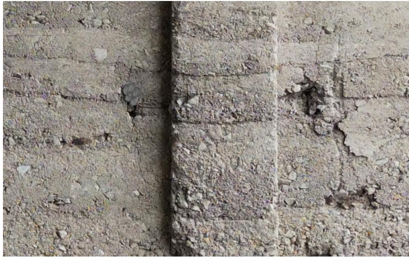
Şekil D.51: Kolon ve duvar yüzeylerinde aşınma.
