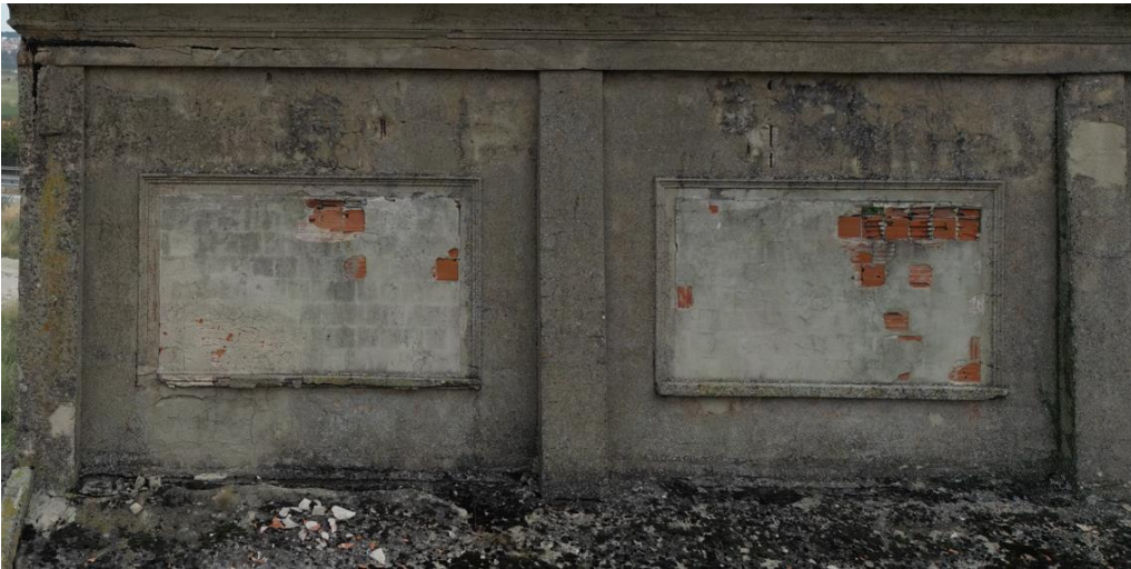
Şekil D.33: Kuzeybatı Cephesinde Kapatılan Pencere Açıklıkları.
