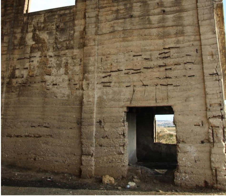
Şekil D.35: Duvar ve kolonlar üzerinde kalıp izleri.
