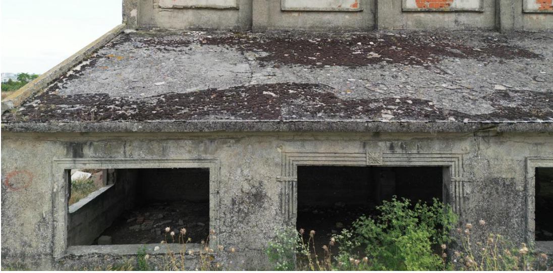
Şekil D.53: Kuzey sahn çatısında yoğun yosun oluşumu.
