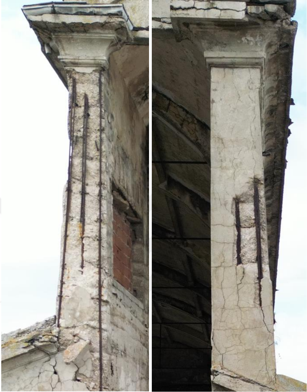
Şekil D.38: Güneybatı cephede kolon yüzeyleri ve donatılar.
