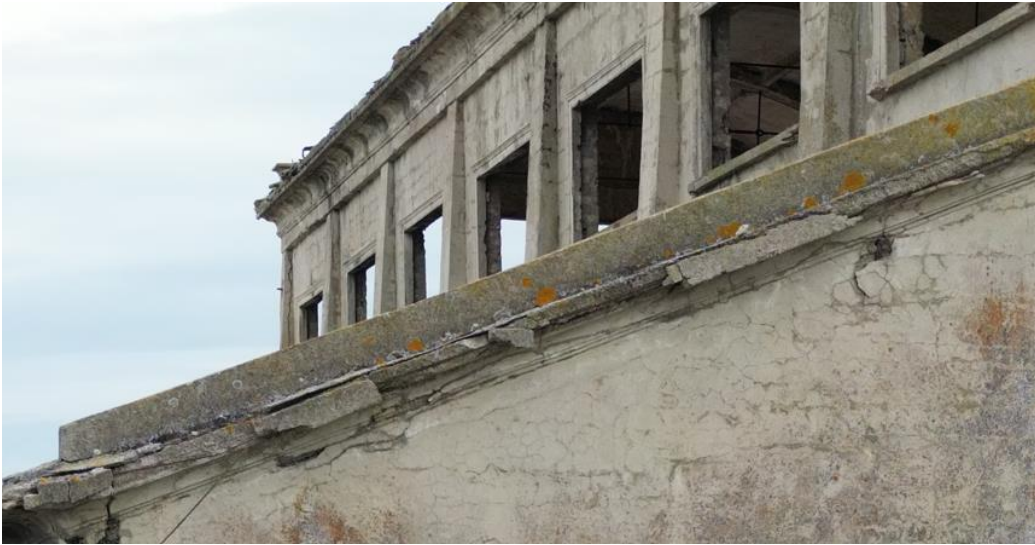
Şekil 3.28 Kuzeydoğu cephesinde saçak ve denizlikte malzeme kaybı
