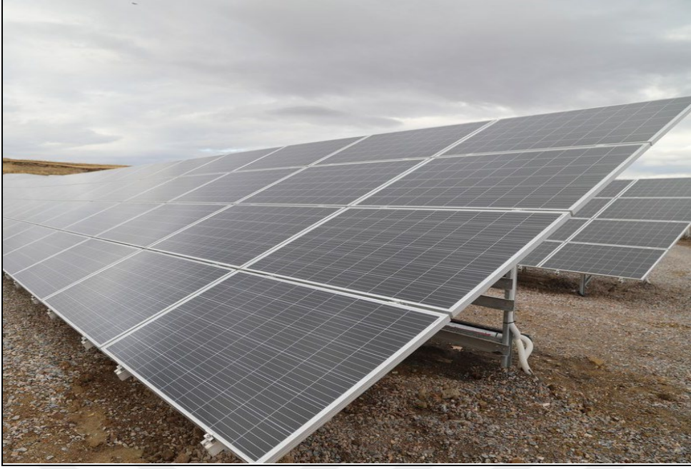
Şekil 3.18. Karatabanlı fotovoltaik sistem örneği.
