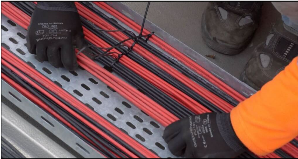
Şekil 5.7. Güneş Enerji Santrallerinde DC Kabloleme[63].
