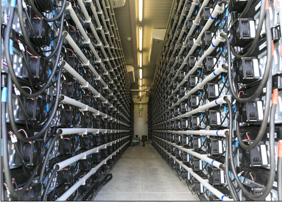
Şekil 3.14. Fotovoltaik sistemde üretilen enerjiyi depo eden bataryalar [42].
