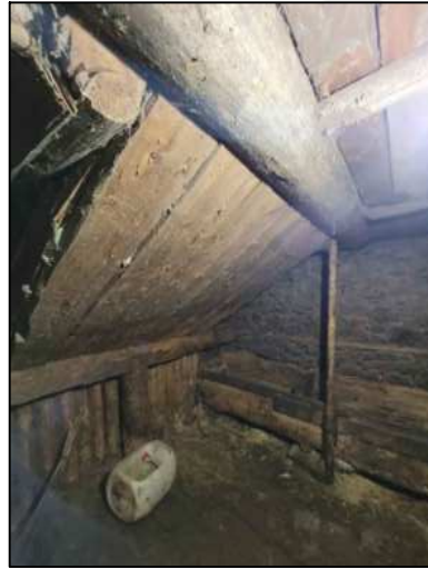
ocağın altındaki taşıyıcı sistem Z07 AHIR
