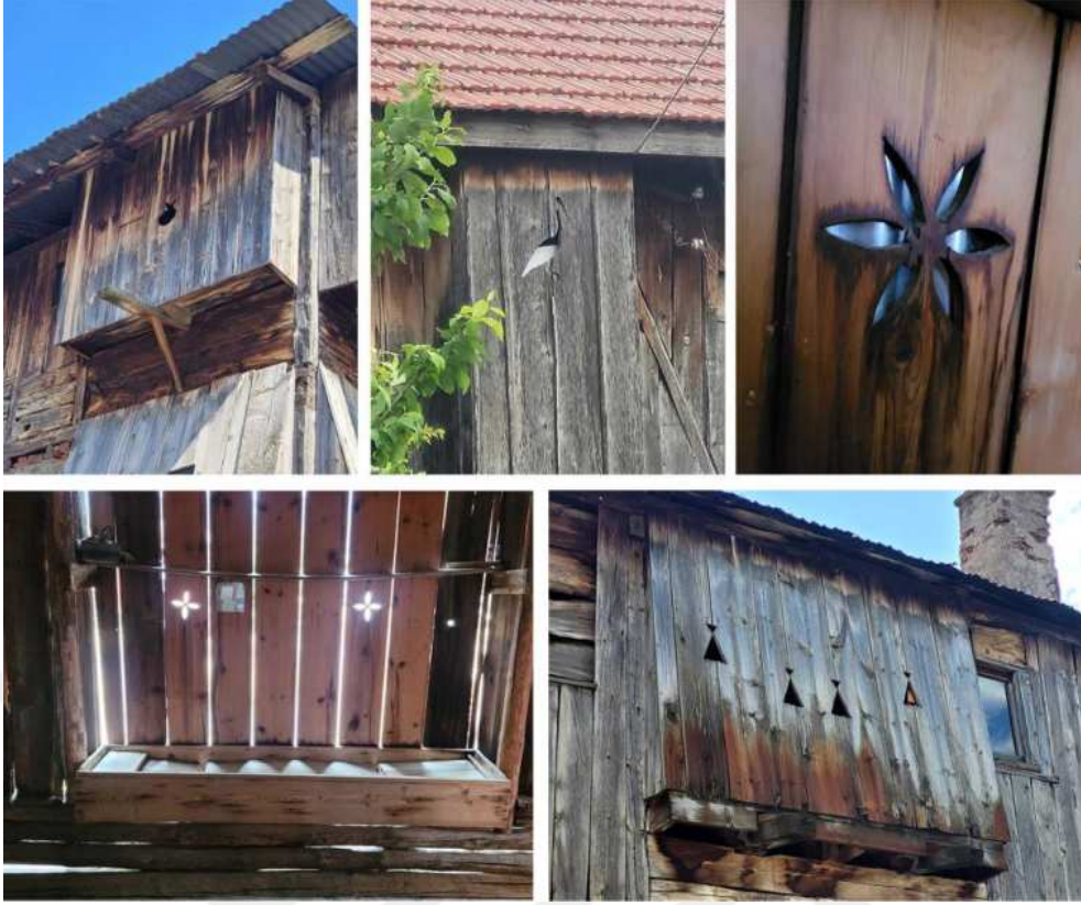
Şekil 5.49 Helallarda havalandırma amaçlı ahşap kaplamalarda açılan boşluklar
