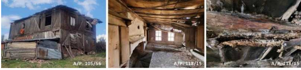
Şekil 6.21 Konutlarda bakımsızlık ve terk sebebiyle oluşan bazı koruma sorunları (2023)
