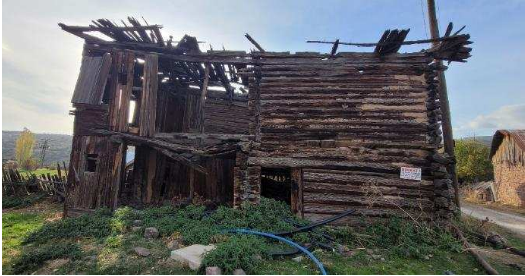
Şekil 4.5 Terk edilmiş ahşap yı ma köy odası (2022)
