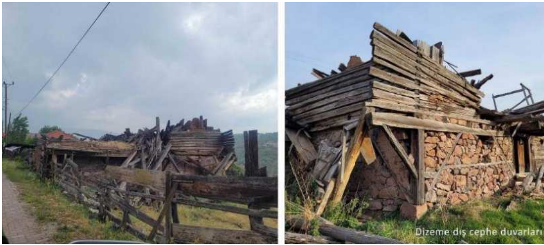
Şekil 6.25 Ada 110, parsel 30’daki üst katı yıkılmış konut (2023)
