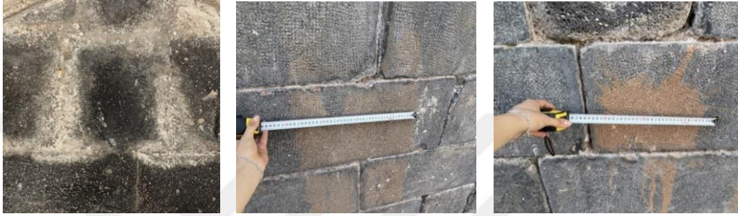
Şekil 4-43:Taş yüzeylerinde oluşan bozulmalar (HS-A, 2022)
