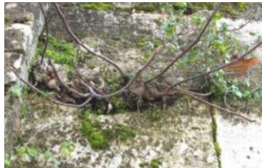
Şekil 2-29: Taş Yüzeyinde Bitki Oluşumu
