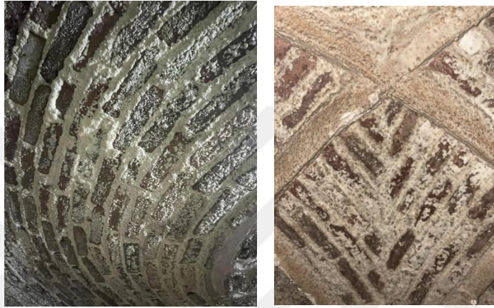
Şekil 4-47: Tuğla yüzeyinde oluşan çiçeklenme (HS-A, 2022)
