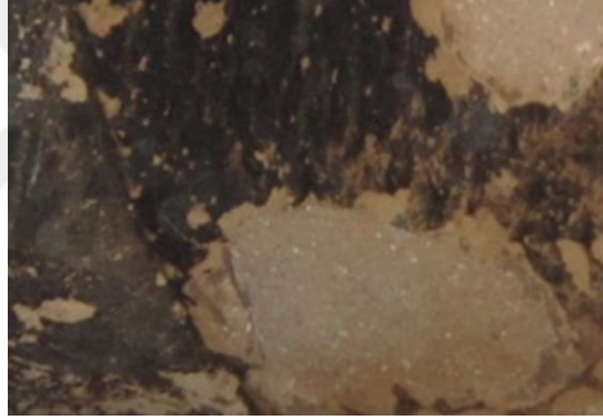
Şekil 2-26: Taş Yüzeyinde Kabuk Oluşumu
