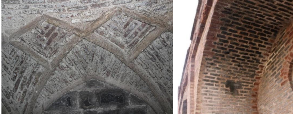
Şekil 3-43: Tuğla yüzeyinde oluşan tuzlanma(sol), Tuğla yüzeyinde oluşan kararmalar (sağ) (HS-A, 2022)
