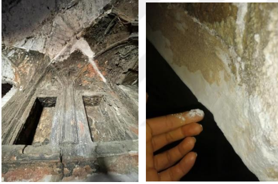
Şekil 4-53: sıva yüzeyinde bozulmalar (HS-A, 2022)
