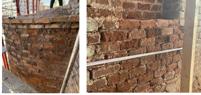
Şekil 4-46: Tuğla malzemedede yüzey kayıpları (HS-A, 2022)
