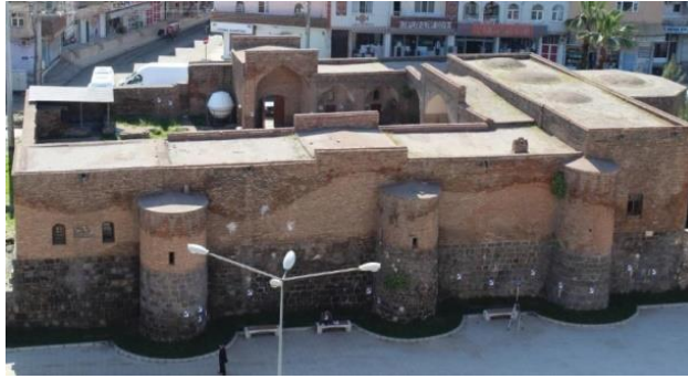
Şekil 4-45: Yapıda çatıdan ve zeminden alınan su izleri
