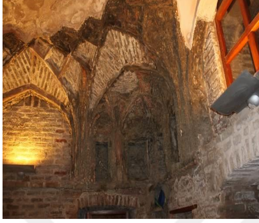
Şekil 4-52: İbrahim-es sori türbesinde sıva dökülmeleri ve kararmalar
