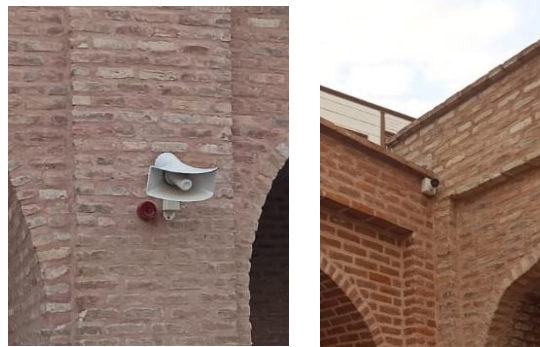
Şekil 4-70: medresede yapılan ses ve kamera sistemi (HS-A, 2022)
