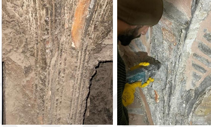
Şekil 4-55: arkası boşalan Sıva yüzeylerin tespit edilmesi (sol), Boşluk olan yüzeylerde delik açılması(sağ) (HS-A, 2022)
