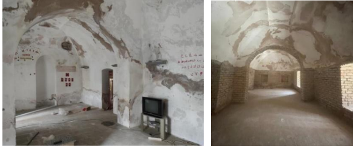
Şekil 4-33: Doğu I hücresi müdahale öncesi durumu(sol), Raspa sonucu tuğla olan duvarlar(sağ),
