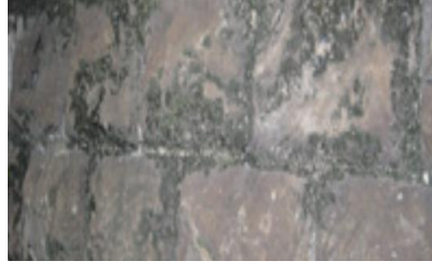
Şekil 2-32: Taş Yüzeyinde Mantar Oluşumu
