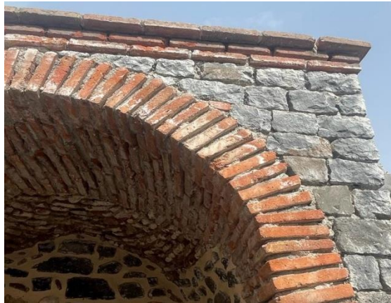
Şekil 2-2: Duvarda derz boşalma örneği Cizre ulu cami giriş kapısı (HS-A, 2022)
