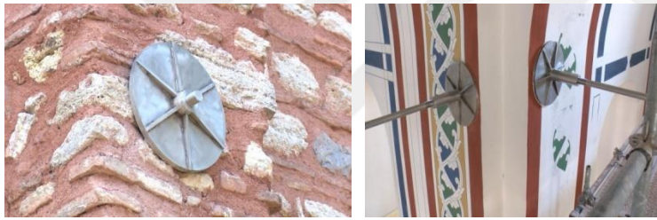
Şekil 2-5: Atik Mustafa Paşa Caminde gergi uygulamalarının dış cephede görünüşü (sol), İç cephede Görünüşü(sağ) (Altıntaş, 2023)
