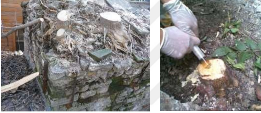
Şekil 2-13: Taş Duvar Üzerinde Gelişen Odunsu Bitkiler(solda), İlacın Enjekte Edilmesi(sağda) (MEB, 2013)
