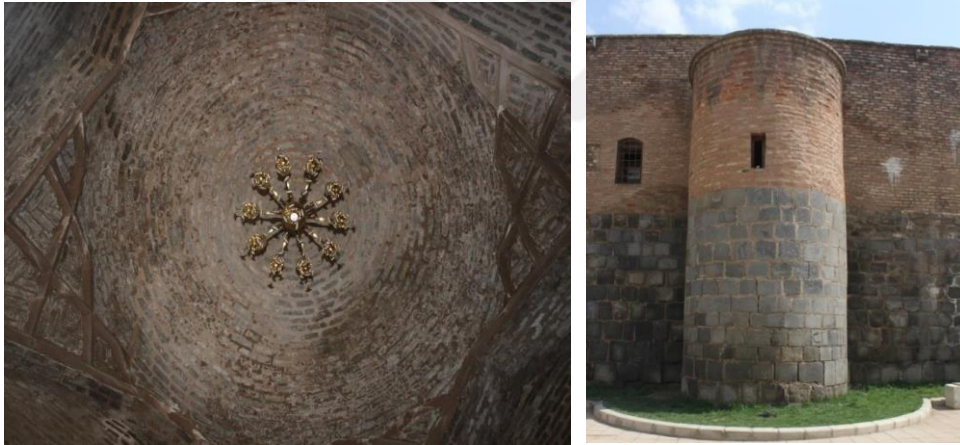
Şekil 3-42: iç mekanda su kaynaklı bozulmalar(sol), Dış cephelerde Su kaynaklı bozulmalar(sağ)
