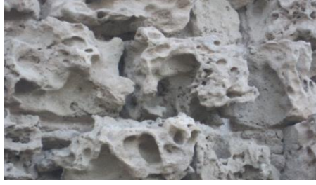
Şekil 2-20: Taş Yüzeyinde Oyuklanma
