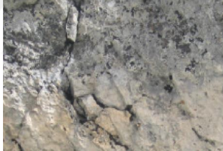
Şekil 2-24: Taş Yüzeyinde Çatlak
