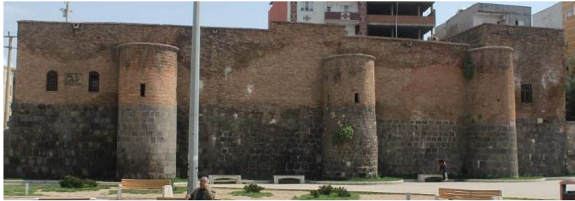
Şekil 4-42: Medrese Batı Cephesinde tuğla ve taş duvar üzerindeki bozulmalar
