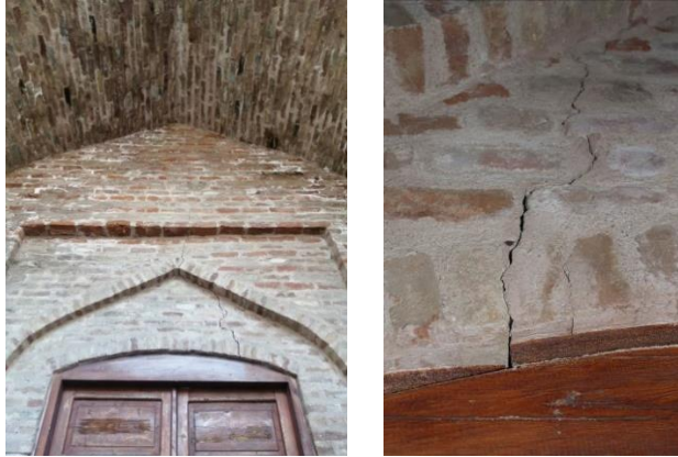
Şekil 4-14: Medrese girişi kapı üstünde çatlak (HS-A, 2022)
