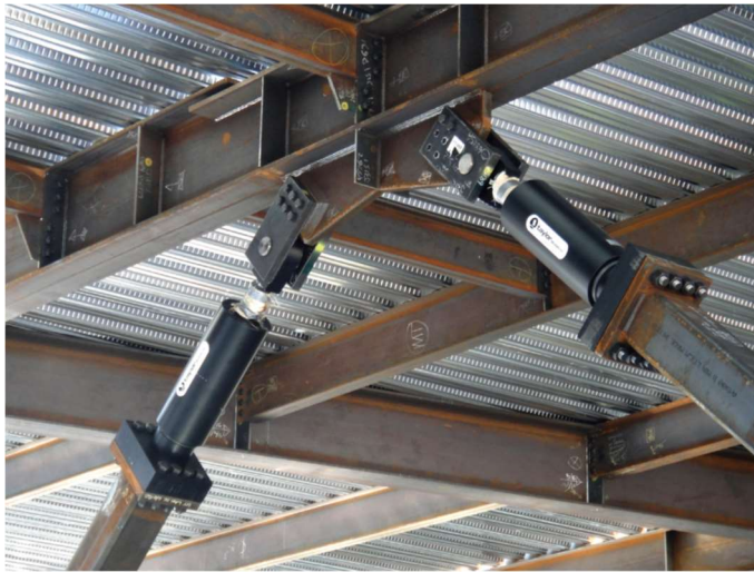
Şekil 2.7 : Montajı tamamlanmış sıvı viskoz sönümleyiciler (Taylor, 2022).
