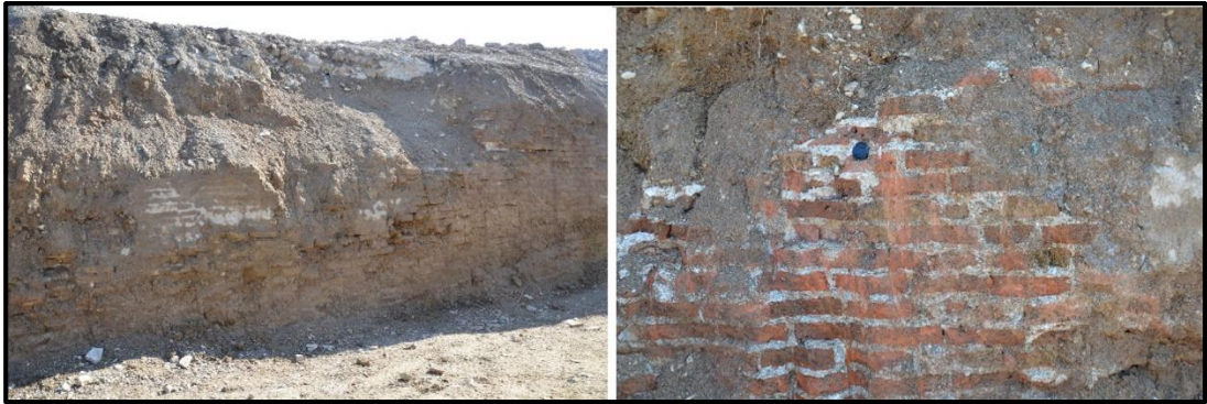
Şekil 4.8. Deprem sonrasında yapıların çökmesi ile ortaya çıkan eski duvar
