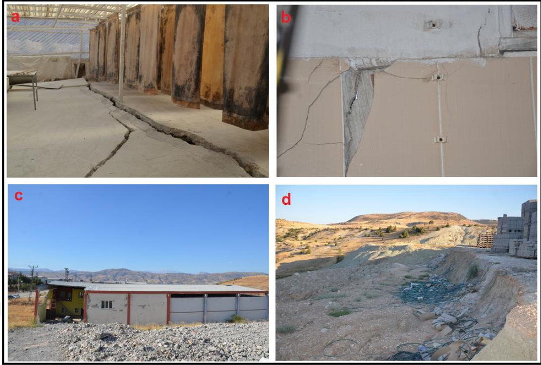
Şekil 4.46. Havzadaki bir fabrika binasında oluşan hasar (a,b,c) ve heyelan nedeniyle oluşan diklik (d)
