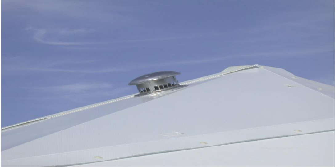
Şekil 14: U-Dome Çatı Havalandırma Deliği (Url-13)
