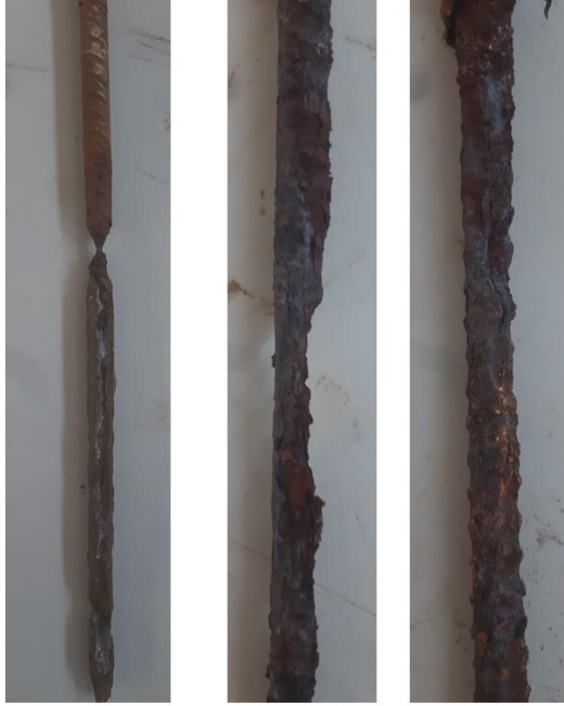
Şekil 3.25. Donatı korozyon hasarı örnekleri
