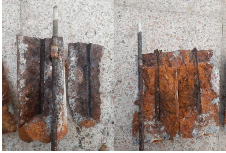
Şekil 3.24. Korozyona uğrayan donatı ve betondaki izi
