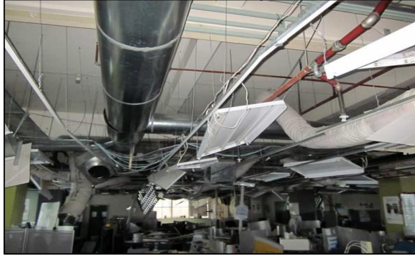
Şekil 3.3: Yapısal olmayan asma tavan mekanik sistem hasarı.
