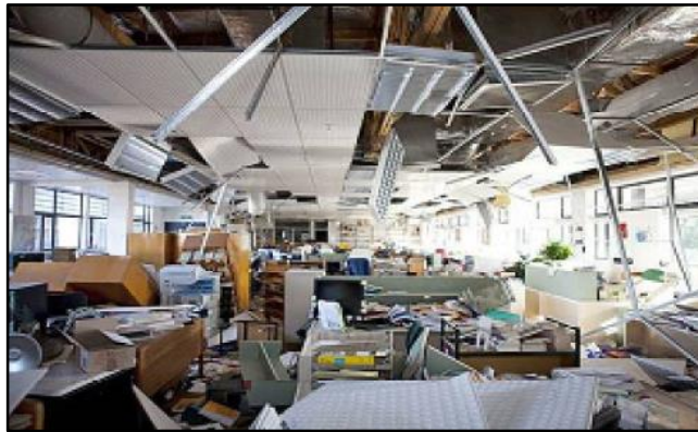
Şekil 3.2: Yapısal olmayan asma tavan hasarı.
