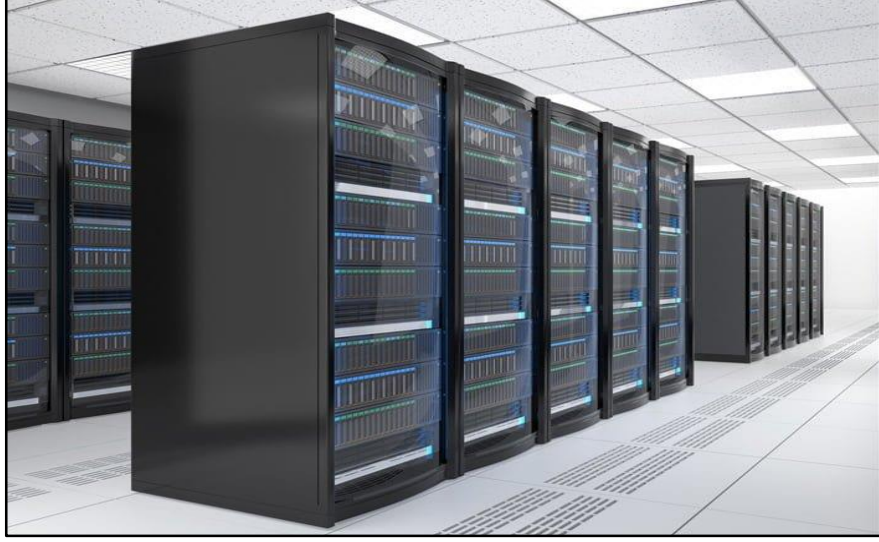
Şekil 3.9: Veri merkezi server dolapları.
