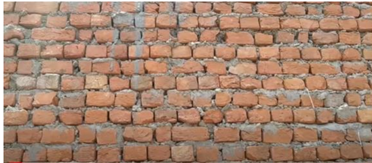
Şekil 3.12 Yanlış Tuğla Örümü
