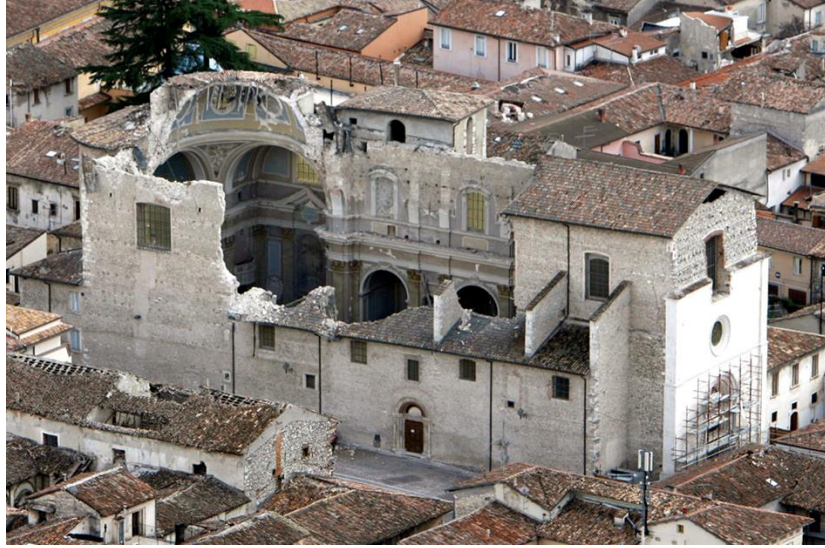
Şekil 6.67 Santa Maria Paganica Kilisesi 2009 Depremi' den Sonraki Çökmüş Hali [139].
