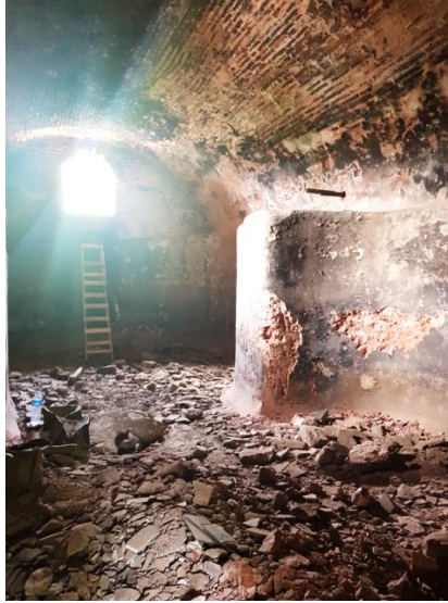
Şekil 3.27 Kağıthane'deki Tescilli Su Sarnıcı Vandalizm Sonucu Zarar Görmesi ( 2020 yılına ait fotoğraf )
