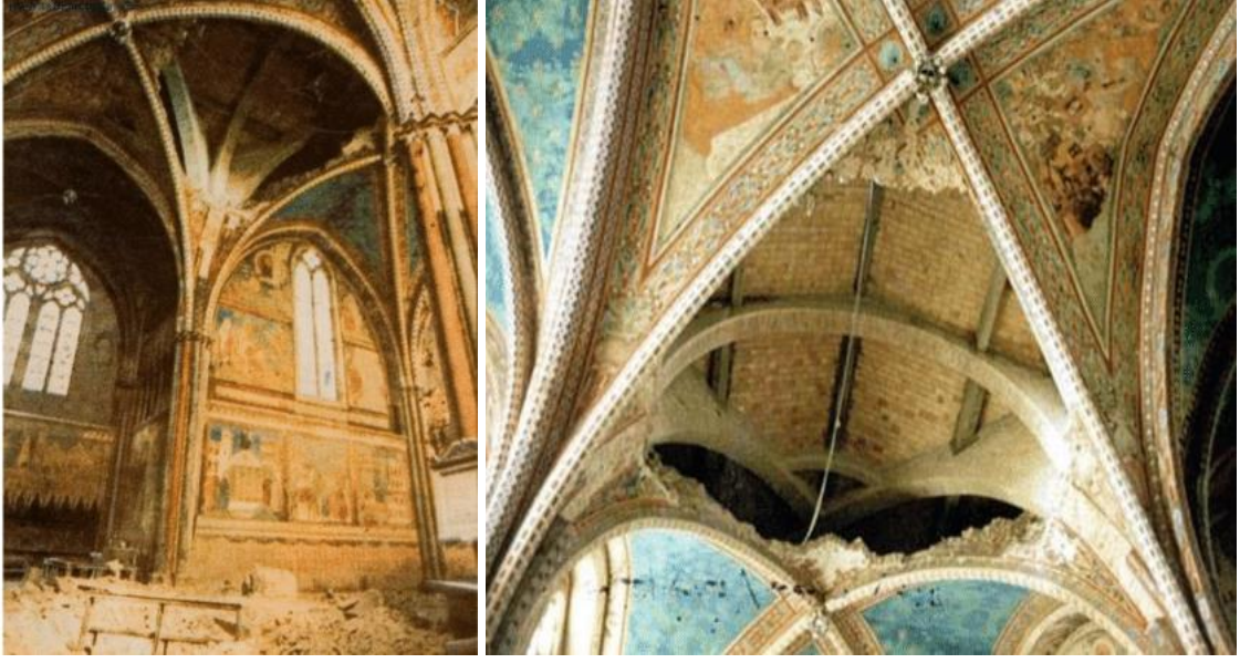
Şekil 6.119 St. Francis Bazilikası 'nın Tonozlarının Çökmesi [66].
