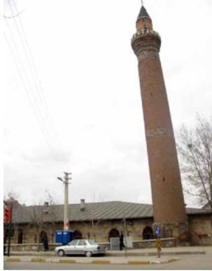
Şekil 3.7 Düşeyden Sapma, Sivas Ulu Camii Minaresi [34]
