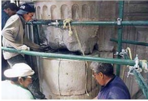
Şekil 6.37 Metropolitan Katedrali'ndeki Sütun Üst Kısımlarındaki Sorun [110]
