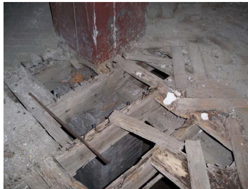
Şekil 3.23 Su ve Nemden Dolayı Ahşap Elemanlarda Bozulma, Büyükada Rum Yetimhanesi [33].
