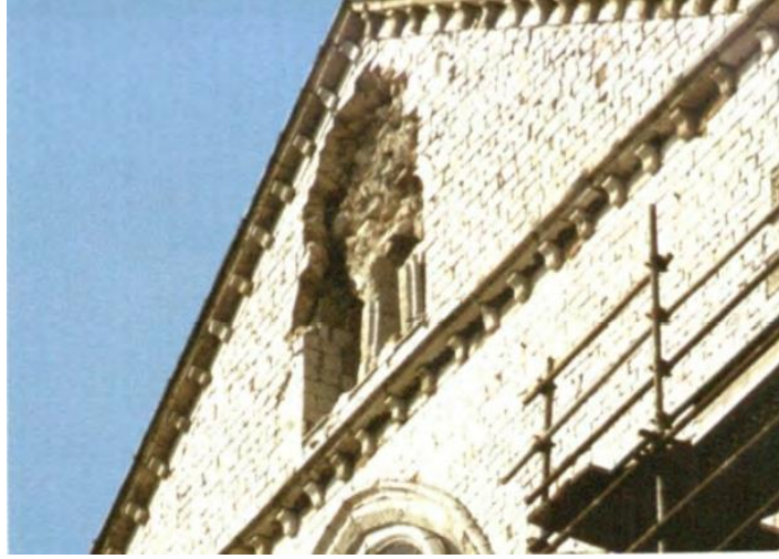
Şekil 6.123 St. Francis Bazilikası'nda Typanum(alın duvar/ kalkan duvar) Hasar [179]
