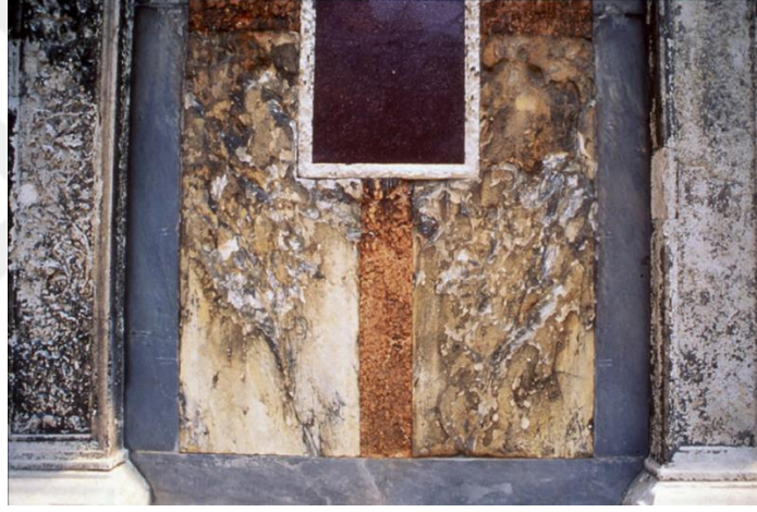
Şekil 6.57 Koruma İşleminde Önce Miracoli'nin Tuz Birikintileri ve Yüzey Kiri İçeren Dış Görünümü [134]
