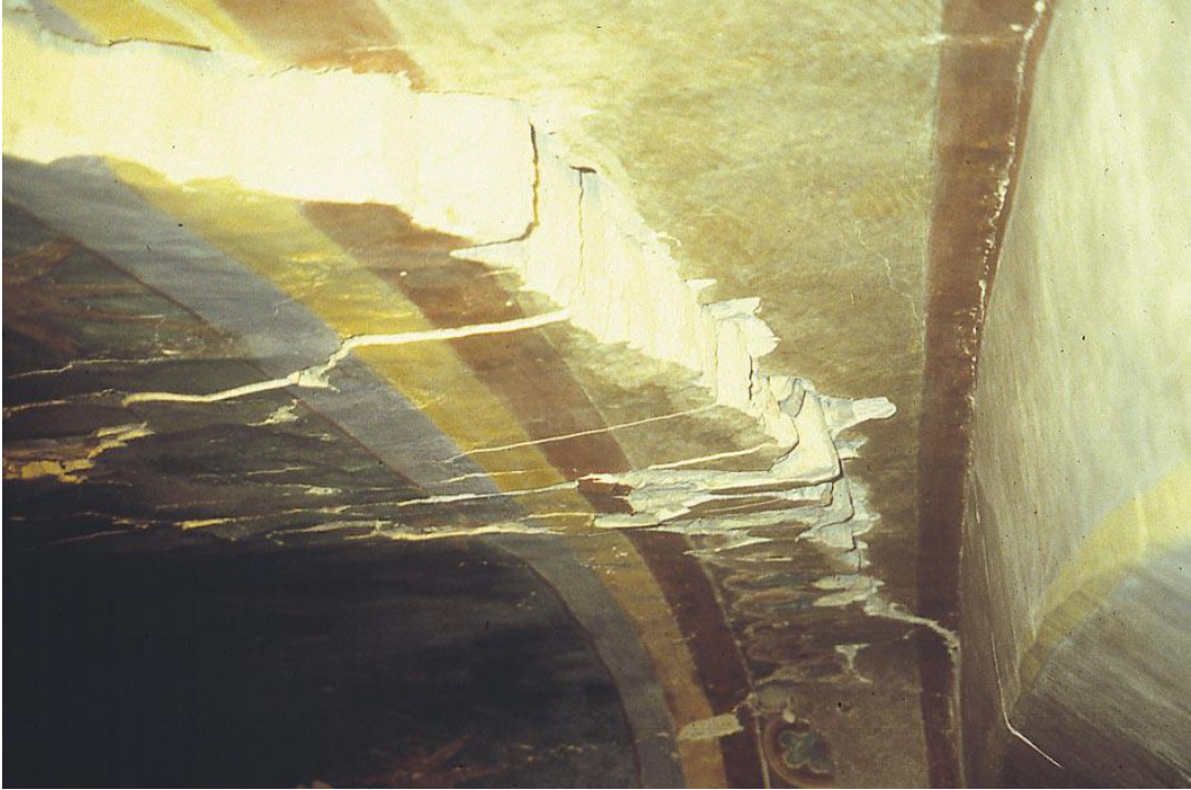
Şekil 6.120 St. Francis Bazilikası'nda Tonozlarda Oluşan Çatlaklar ve Deformasyonlar [66]
