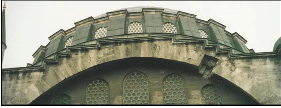
Şekil 3.18 1999 Depreminde Edirnekapı Mihrimah Sultan Camii Kemerinde Oluşan Hasar [41].
