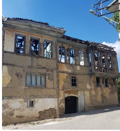
Şekil 3.25 Sakarya, Taraklı Tarihi Evde Bakımsızlıktan Dolayı Yapının Hasar Görmesi
