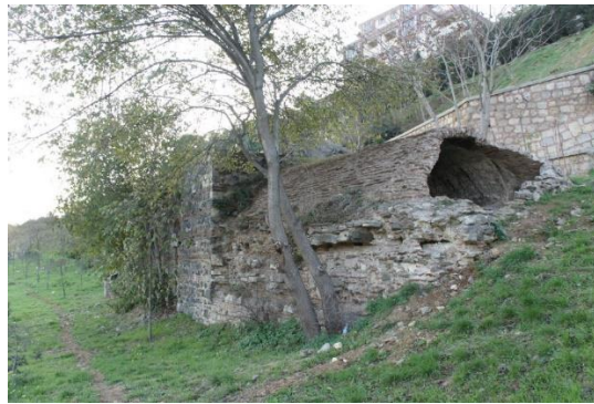
Şekil 3.26 Kağıthane’deki Tescilli Su Sarnıcı Bakımsızlık ve Yapının Kullanılmamasından Dolayı Hasar Alması ( 2020 yılına ait fotoğraf )
