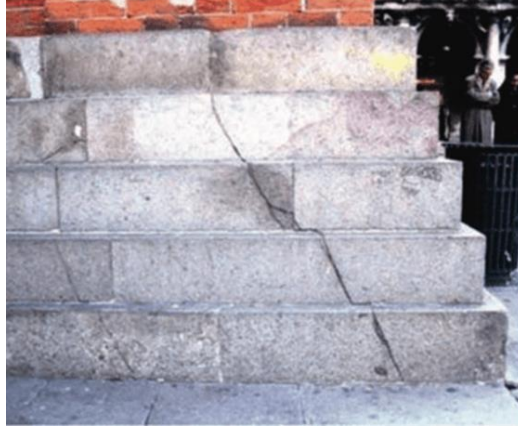
Şekil 6.99 San Marco Çan Kulesindeki Basamaklarda Oluşan Çatlaklar [161]
