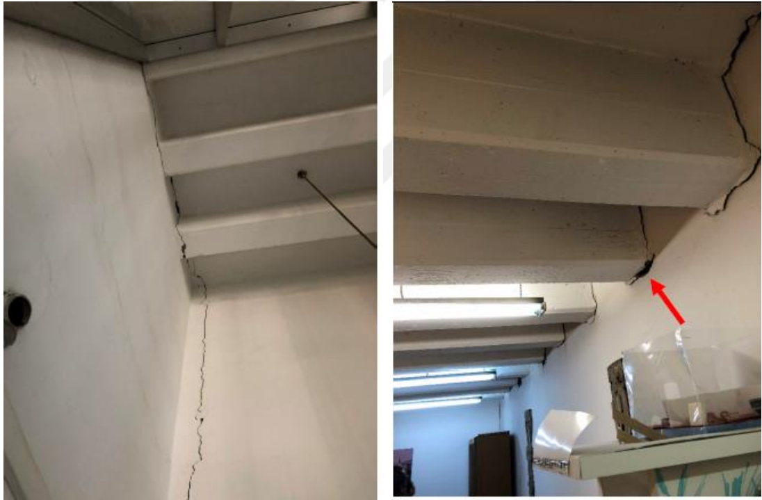
Şekil 6.139 Mimar Sinan Mimarlık Fakültesi'nde Betonarme Kirişli Döşeme ile Yığma Duvar Arasında Oluşan Çatlaklar ve Ayrılmalar [182].
