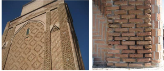
Şekil 3.24 Kayseri Melik Gazi Türbesi Derzlerin Boşalması [46]
