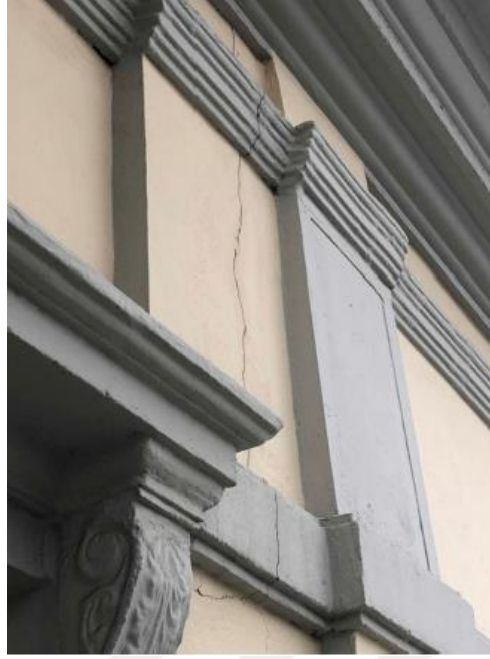
Şekil 6.140 Mimar Sinan Mimarlık Fakültesi'nde Yan Dış Cephesindeki Çatlaklar [182].
