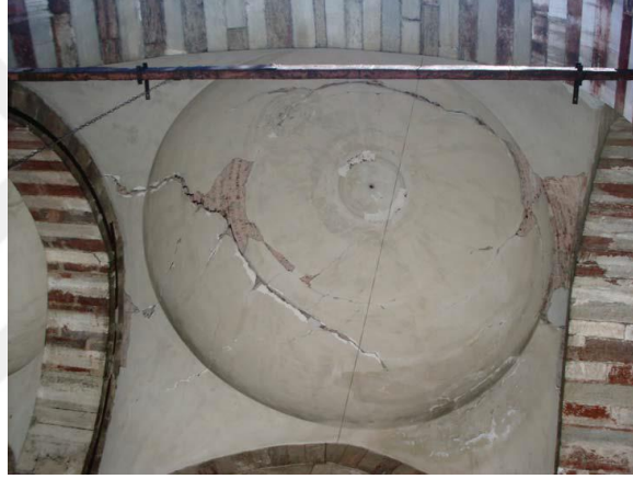
Şekil 3.6 Kubbede Meydana Gelen Dairesel Çatlaklar, Fatih Külliyesi [33].
