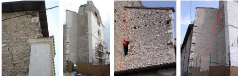
Şekil 6.69 Santa Maria Paganica Kilisesi'ndeki Çatlaklar [140]
