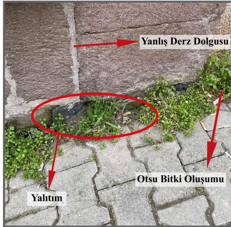
Şekil 5.12: Karesi İdadisi Kuzeybatı Cephesi Yalıtım ve Yüzey Bozulmaları
