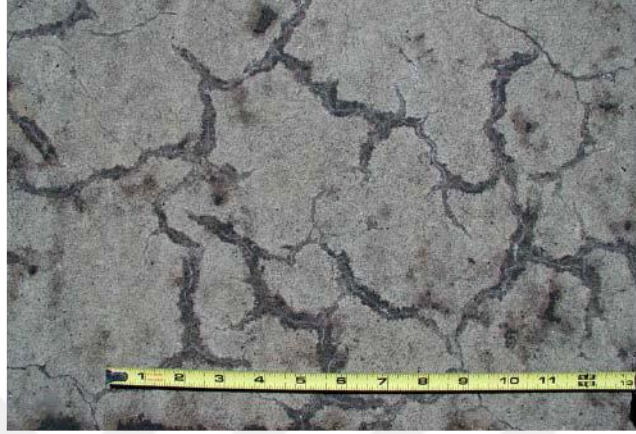
Şekil 8. Çatlaklardan sızan yüzeyel tortular
