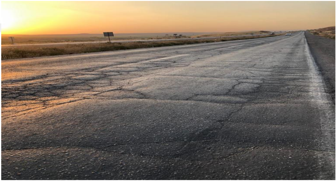
Şekil 1.12. Silopi-Cizre Karayolu Yolunun Eski Kısımındaki Yorulma Çatlakları (2022)
