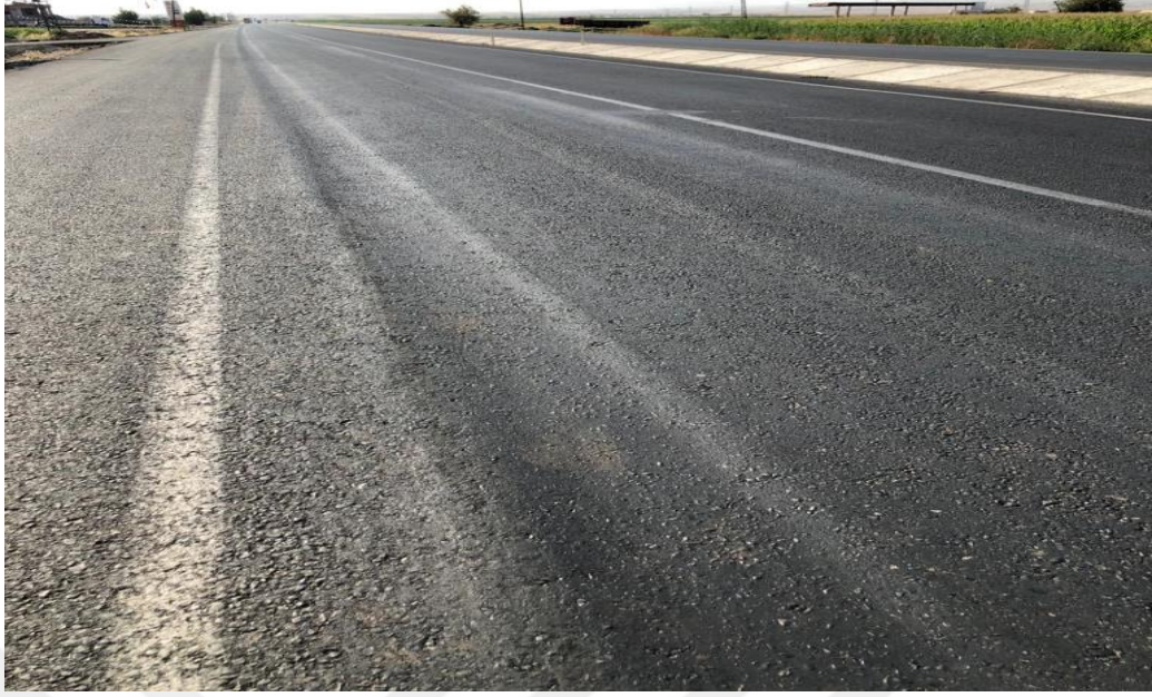
Şekil 1.8. Silopi-Cizre Karayolu Yolunun Yeni Yapılan Kısımındaki Tekerlek İzi Hasarları (2022)
