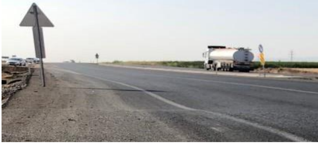
Şekil 1.10. Silopi-Cizre Karayolu Yeni Yapılan Kısımındaki Lokal Oturma (2022)
