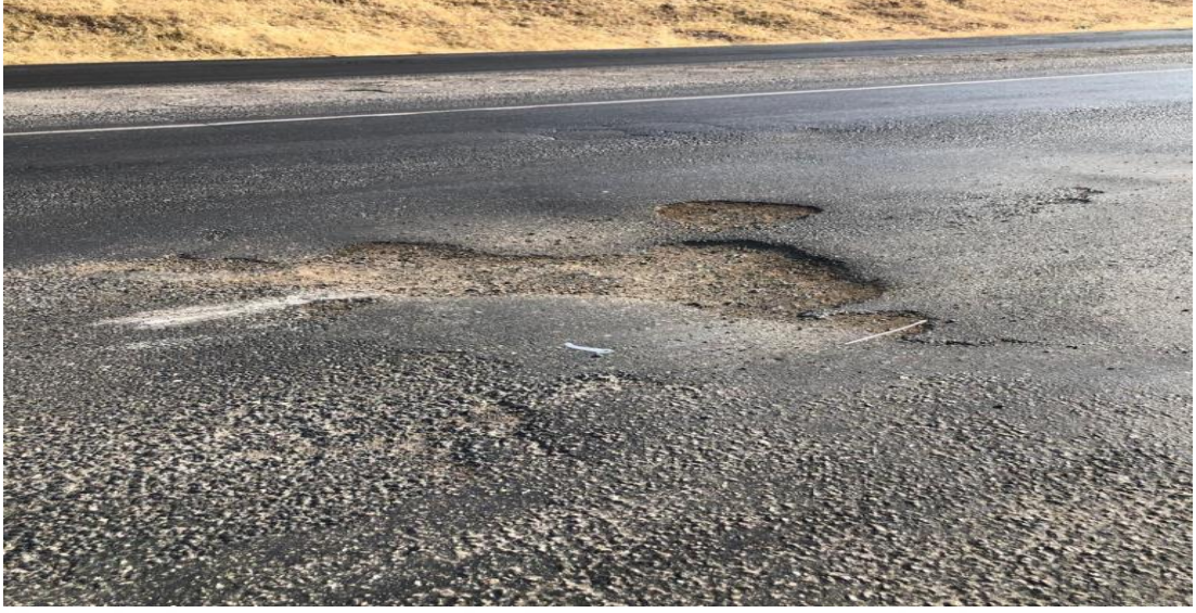
Şekil 1.15. Silopi-Cizre Karayolunun Eski Kısımındaki Çukurlar (2022)
