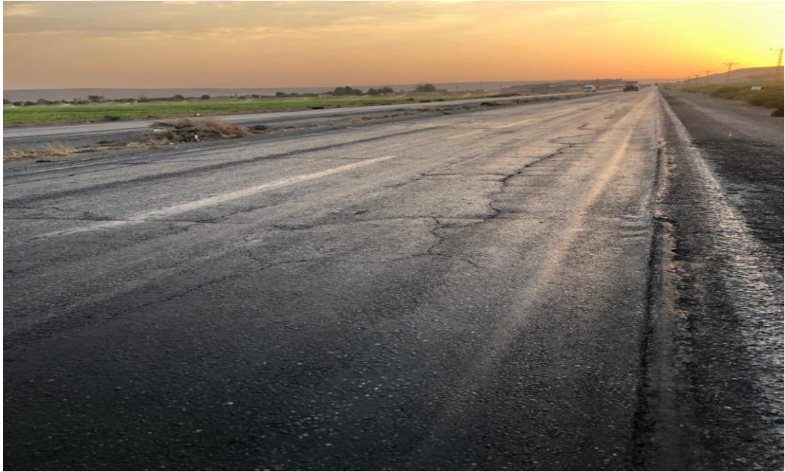
Şekil 1.9. Silopi-Cizre Karayolunun Eski Kısımındaki Tekerlek İzi Hasarları (2022)
