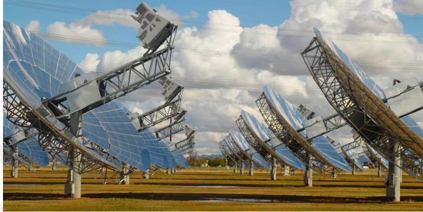
Şekil 3.15. Parabolik çanak tipi güneş toplayıcıları (Maricopa Solar Project, 2011).
