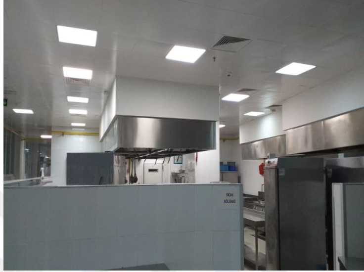
Şekil 1.4. Mutfak Bölümü Aydınlatma Sistemi
