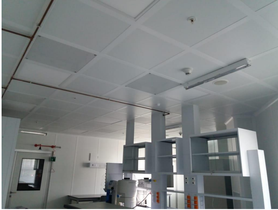
Şekil 5.9 NU Temiz Odalarında Kullanılan HPL Tavan Kaplama Örneğİ (Ümit KALENDEROĞLU, 10.04.2018)
