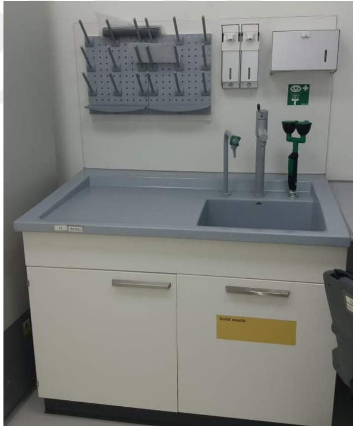
Şekil 5.21 NU Laboratuvarında Kullanılan Yıkama Ünitesinin Modeli (Serhan TUĞCU 07.05.2018)
