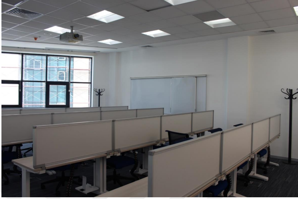
Şekil 4.48 NU Bilgisayar Dersliği İç Mekan Görünümü – 2 (Muhammet AKDERE, 23.03.2018) Mahaldeki hava konforunun en iyi şekilde sağlanabilmesi adına havalandırma emiş ve üfleme menfezleri mahal içerisinde eşit olarak dağıtılmıştır. Aydınlatma armatürleri modüler 600 x600 mm taşıyıcı panellerin arasına aydınlatma hesapları göz önünde bulundurularak, mahal tavan planına homojen olarak yerleştirilmiştir (Şekil 4.48). NU Bilgisayar Dersliği'nde kullanılan kaplama tipleri ve mahal alan bilgileri aşağıdaki gibidir (Tablo 4.26).
