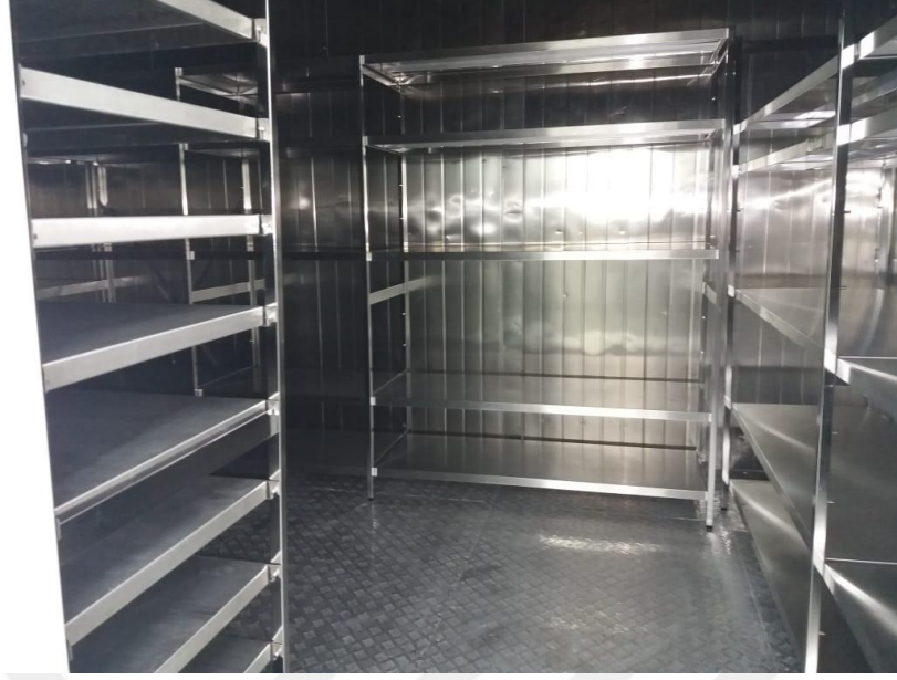
Şekil 5.55 NU Soğuk Oda İç Mekan Görünümü-2 (Aidana BATPANOVA, 18.04.2018)
