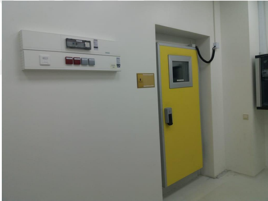
Şekil 5.54 NU Soğuk Oda İç Mekan Görünümü-1 (Aidana BATPANOVA, 05.04.2018)
