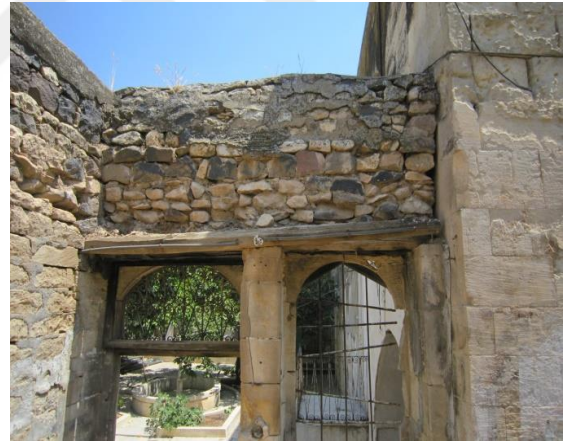
Şekil 4.41: Üst örtüsü yıkılan mutfak.
