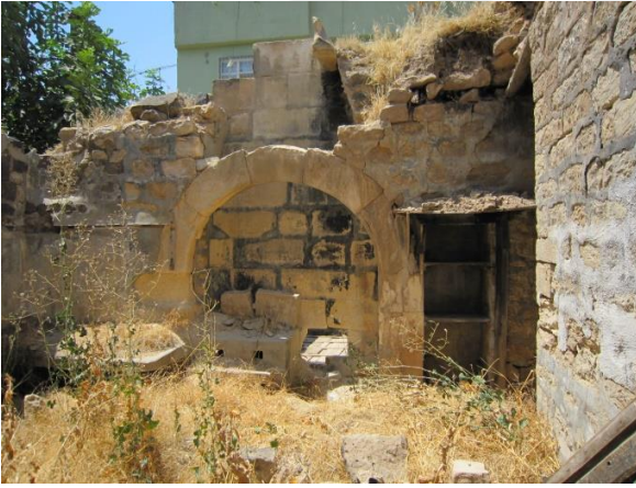
Şekil 4.40: Üst örtüsü yıkılan mutfak.
