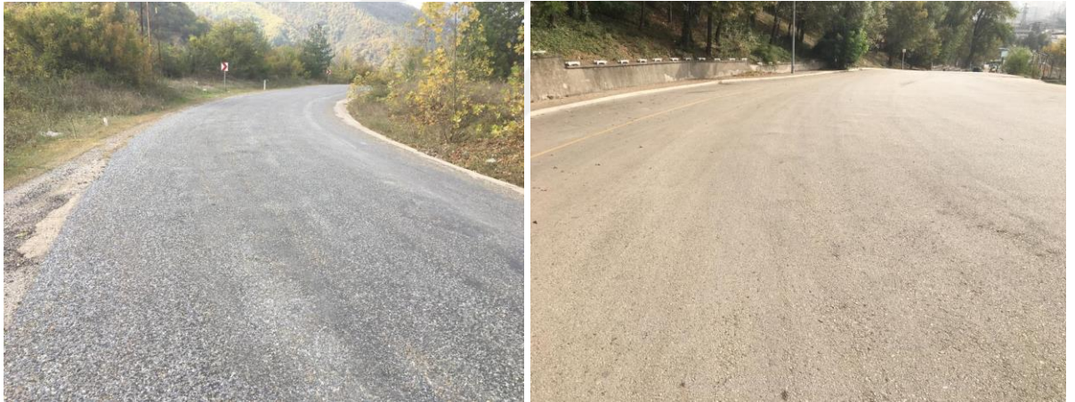
Şekil 2.15. Esnek üstyapılarda ondülasyon şeklinde oluşan deformasyonlar. a) Yenice–Saray köy yolu b) Karabük-Merkez)
