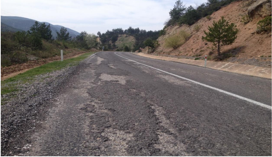
Şekil 2.17. Esnek üstyapılarda sökölme kaynaklı oluşan deformasyonlar. (Karabük-Ovacık bağlantı yolu.)
