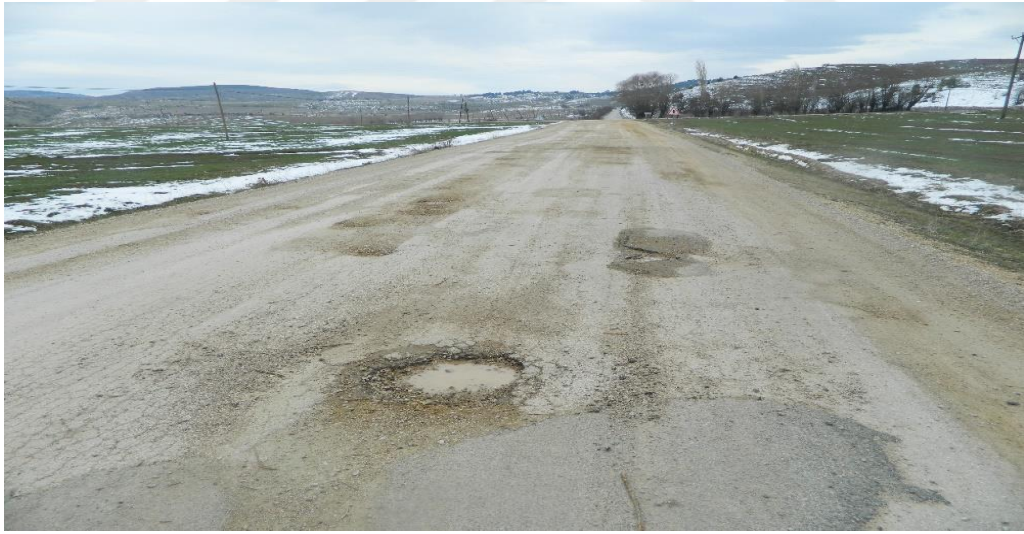
Şekil 5.5. Donma-çözülme olayı sonrası yolda oluşan oyulmalar.
