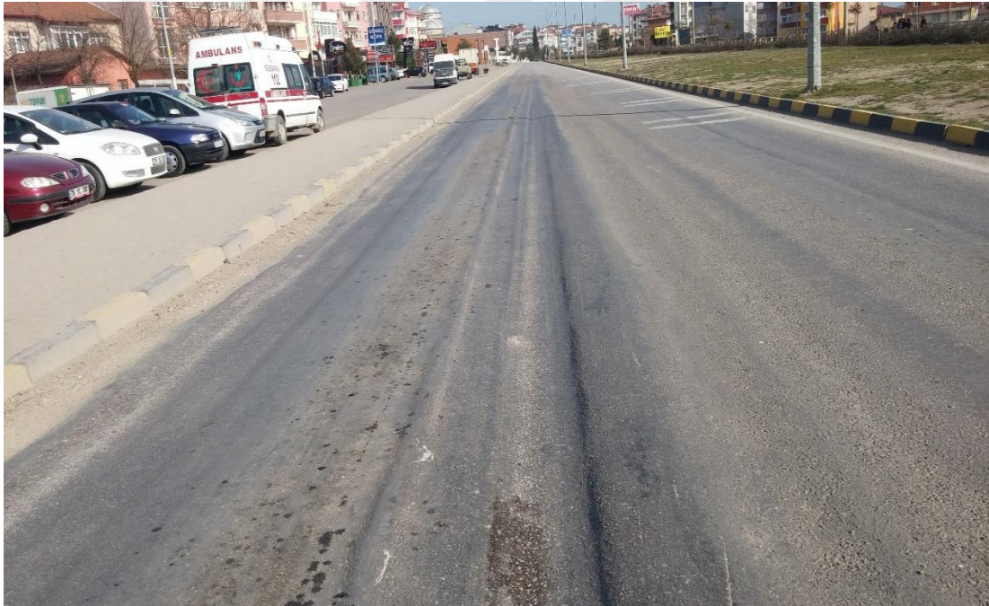
Şekil 2.14. Esnek üstyapılarda tekerlek izi şeklinde oluşan deformasyonlar. (Karabük- Kastamonu yolu)
