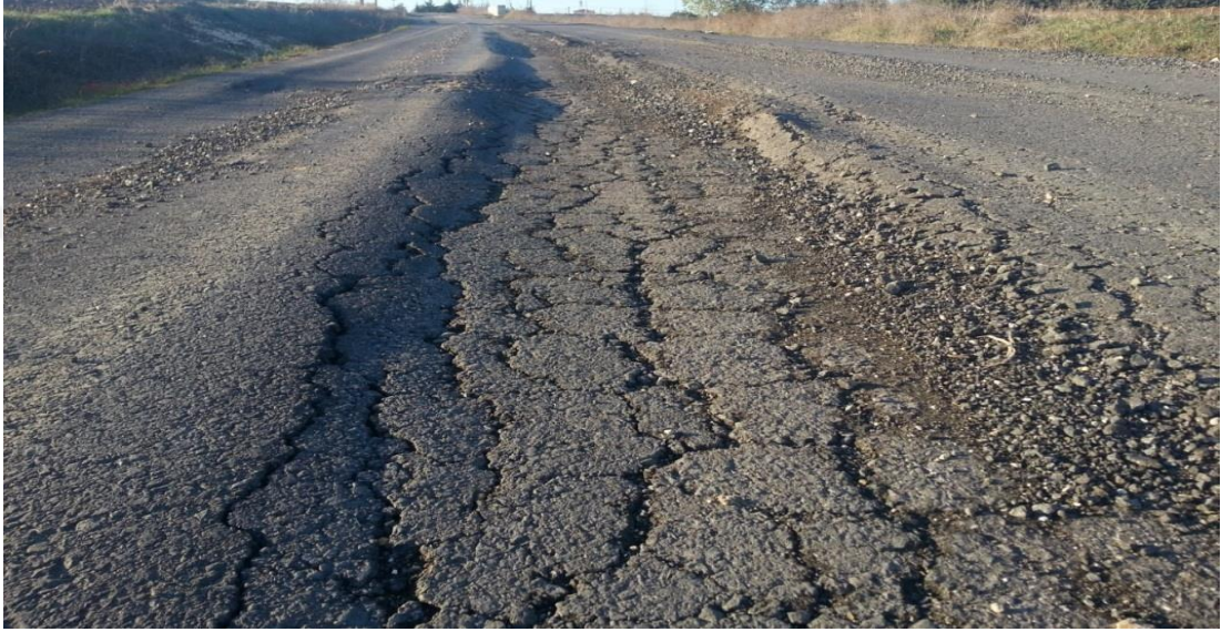
Şekil 2.16. Esnek üstyapılarda oturmada kaynaklı oluşan deformasyonlar [29].
