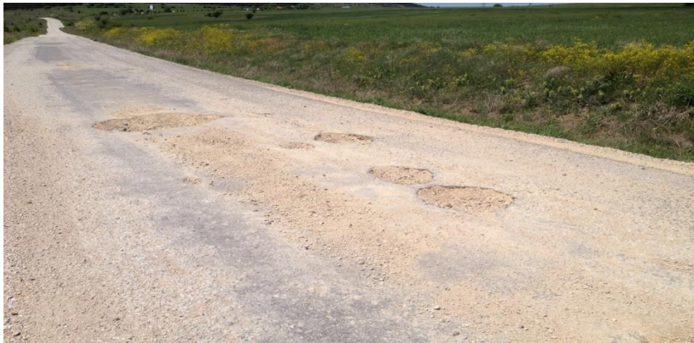
Şekil 5.8. Eskipazar ky yollarının muhtelif yerlerinde oluřan timsah sırtı atlakları.
