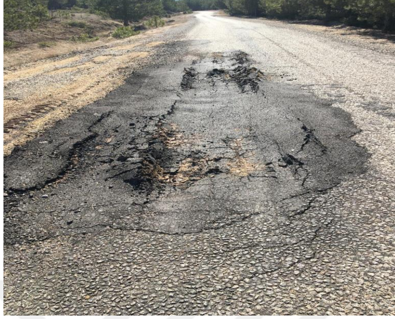
Şekil 2.18. Esnek üstyapılarda kabarmadan kaynaklı oluşan deformasyonlar (Safranbolu-Düzce Köyü)
