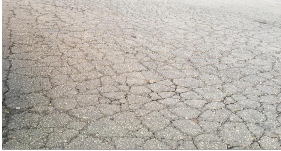
Şekil 2.9. Yüksek yoğunluklu timsah sırtı çatlağı şeklindeki deformasyonlar. (Emek Mahallesi/ Safranbolu)
