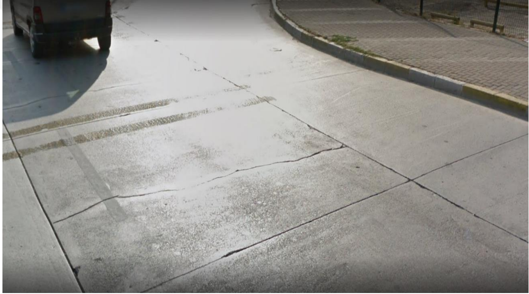
Şekil 2.32. Beton yolda meydana gelen enine çatlak.(Kocaeli-Karamürsel)
