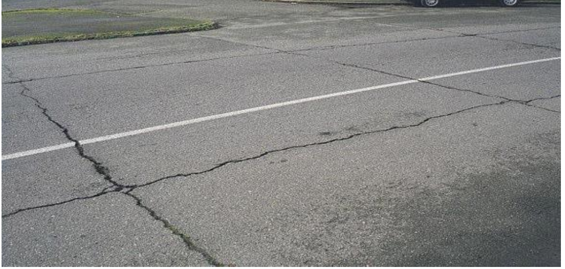
Şekil 2.12. Esnek üstyapılarda derz çatlağı şeklinde oluşan deformasyonlar [23].
