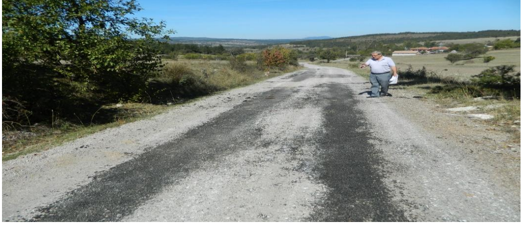
Şekil 5.6. Sathi kaplamalı yolda meydana gelen sklmeler.
