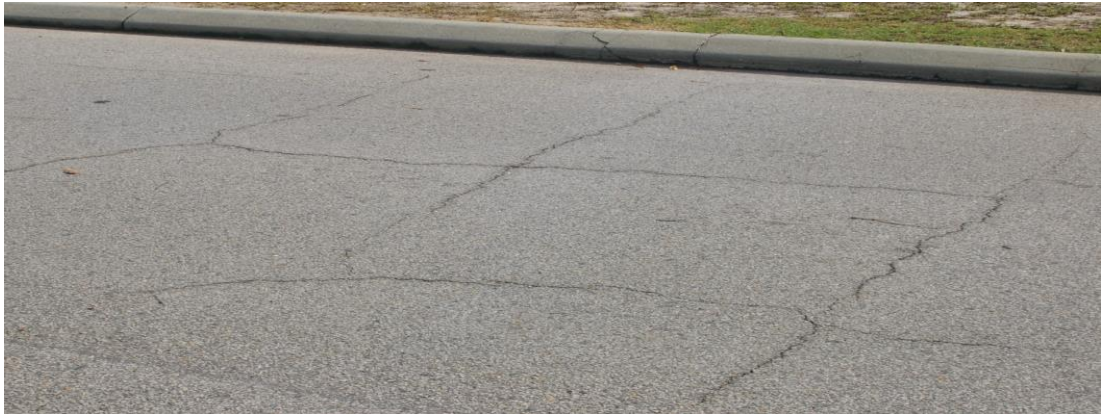
Şekil 2.10. Esnek üstyapılarda büzölme çatlağı şeklindeki deformasyonlar [22].
