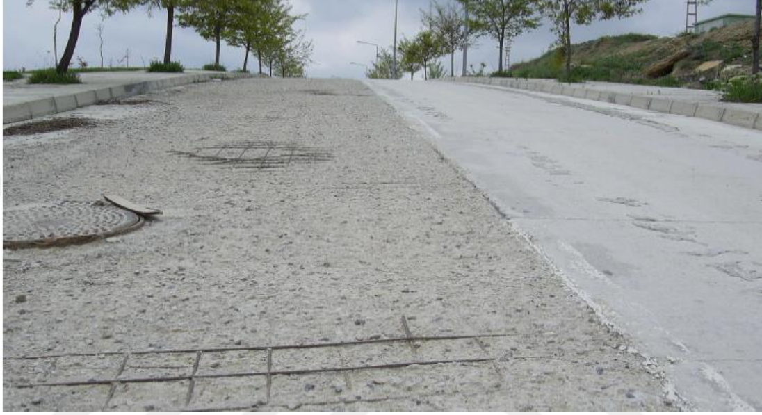
Şekil 2.33. 18 yıl sonunda hizmet ömrünü tamamlayan beton yol. (Ankara-Eskişehir yolu)
