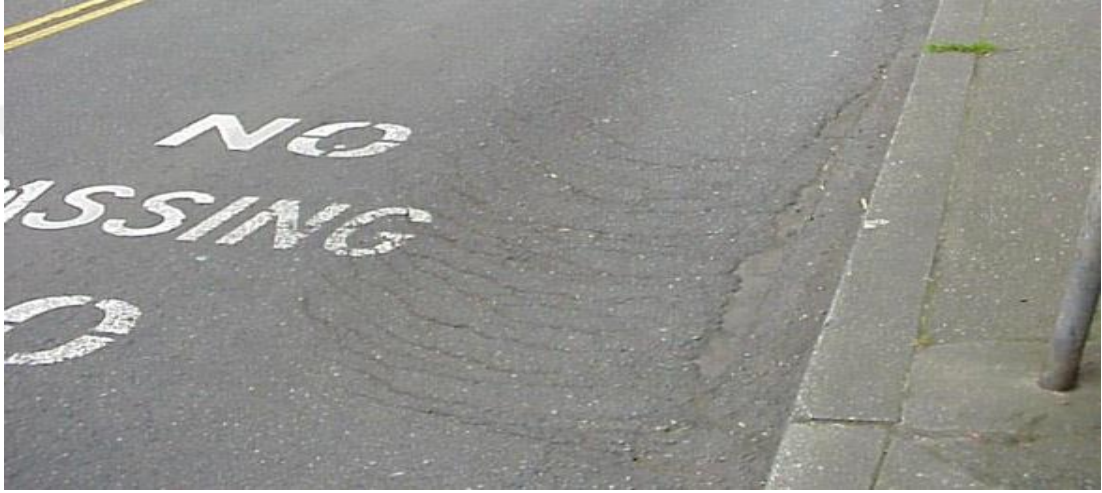
Şekil 2.11. Esnek üstyapılarda kayma çatlağı şeklinde oluşan deformasyonlar [23].
