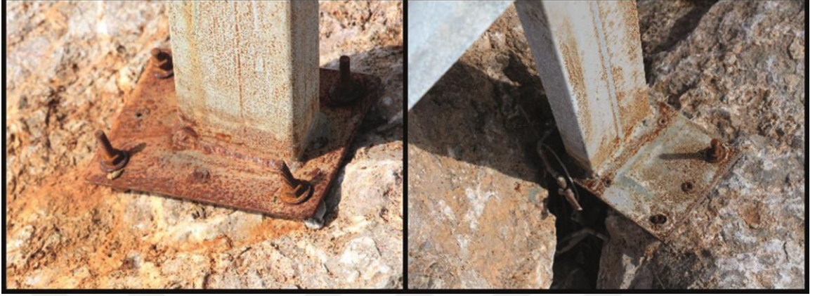
Şekil 21. Zarar gören iskelet bağlantıları (Özgün)
