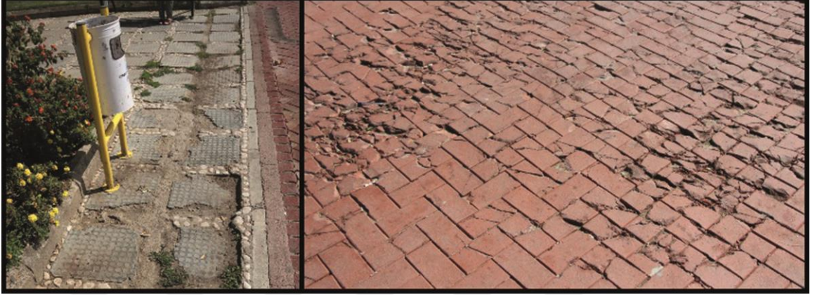
Şekil 29. Düzenlemeye tabi tutulmayan kısımdaki bakım onarım eksiklikleri (Özgün)
