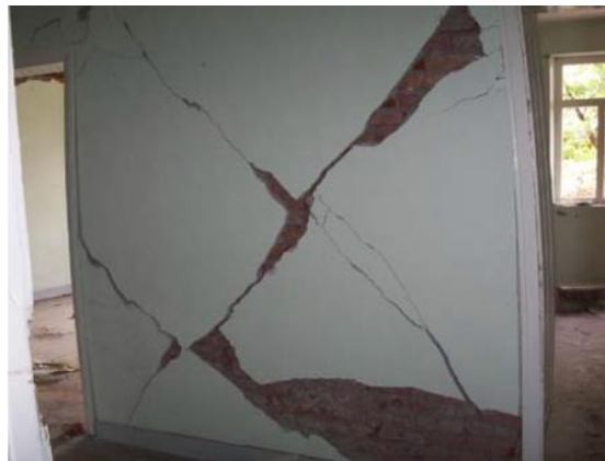
Şekil 3.10: Yığma yapılarda kesme hasarı (Doğangün ve ark., 2008).
