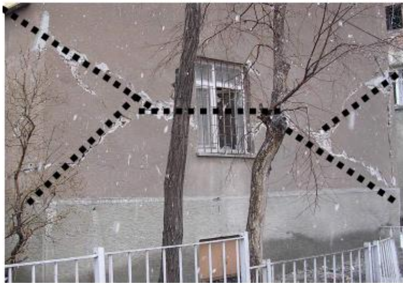
Şekil 3.15: Yığma yapı duvarında oluşmuş basamaklı çatlak .(Korkmaz, 2007)
