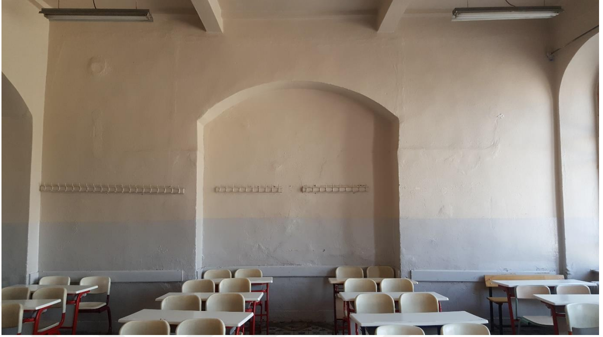
Şekil 4.1.1 : Sonradan İlave Edilen Briket Duvar Örneği.
