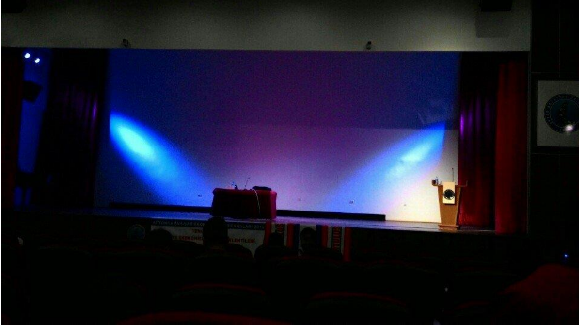
Şekil 71. Sahne Aydınlatması Renkli Par Armatür
