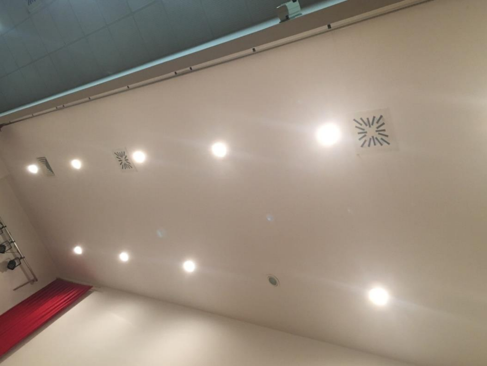
Şekil 73. Sahne Tavanının Spot Lamba İle Aydınlatılması
