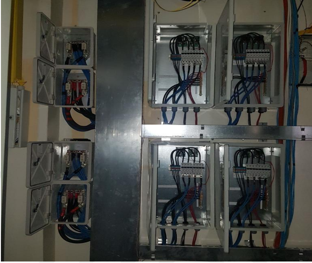
Şekil 6.15. DC dağıtım panosu-1
