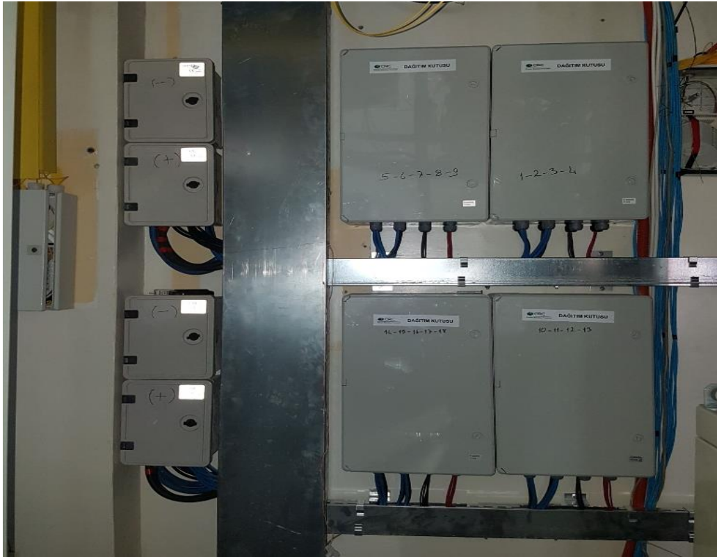
Şekil 6.16. DC dağıtım panosu-2
