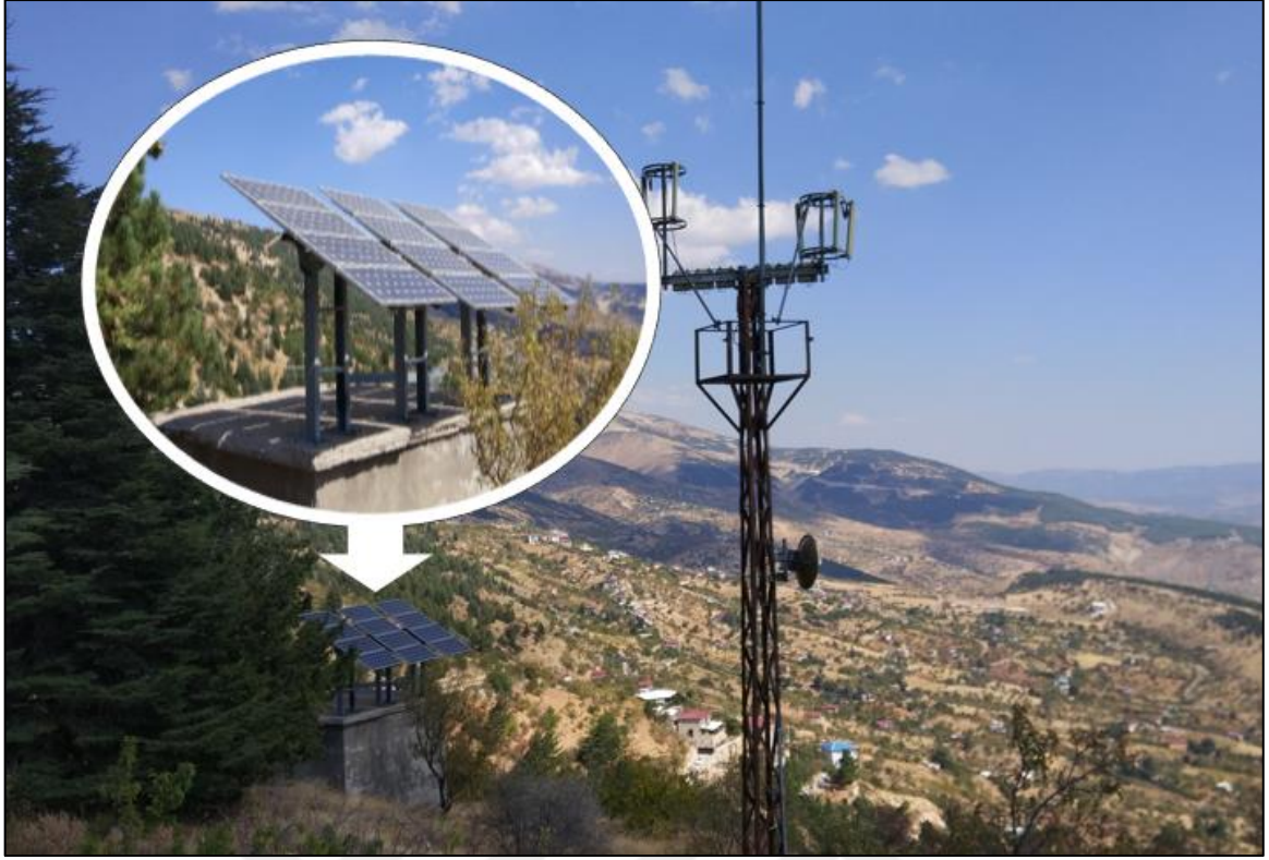
Şekil 6.2.Sulutarla Kahramanmaraş Güneş Enerjili Telekomünikasyon Sistemi
