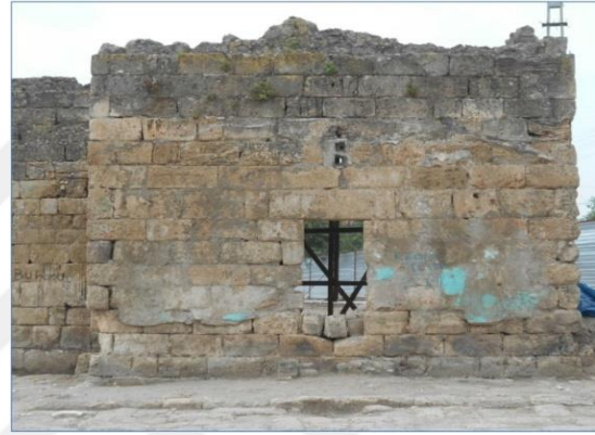
Şekil 111. Eyvan duvarlarındaki moloz taş dolgu
