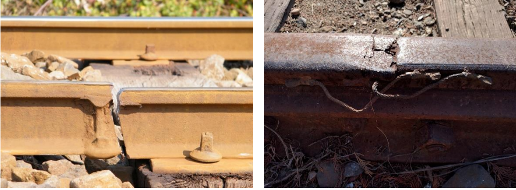
Şekil 1.2. Ray kırılması arızası
