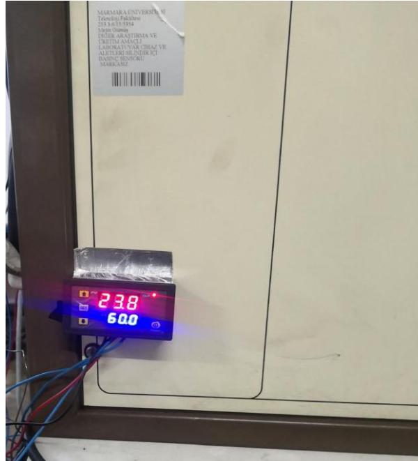
Şekil 2.15. Sıcaklık kontrol paneli
