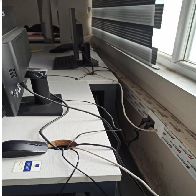
Şekil 4.7. Kanal ile Sabitlenmiş Kablolar
