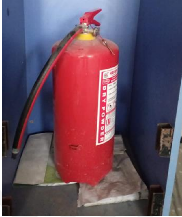
Şekil 4.12. Yangın Tüplerinin Yetersiz Olması
