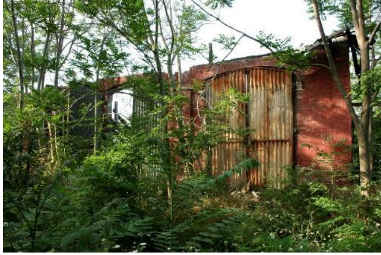
Görsel 142: Vagonaj binası ve bakımsız durumu.
