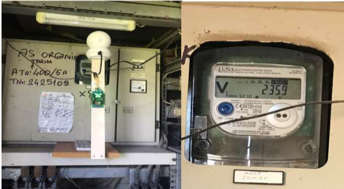
Resim 3.7. Sera Elektrik Sayacı
