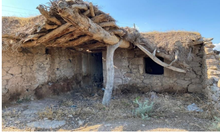
Görsel 2. Yukarıköy’de depremde hasar görmüş taş ev.
