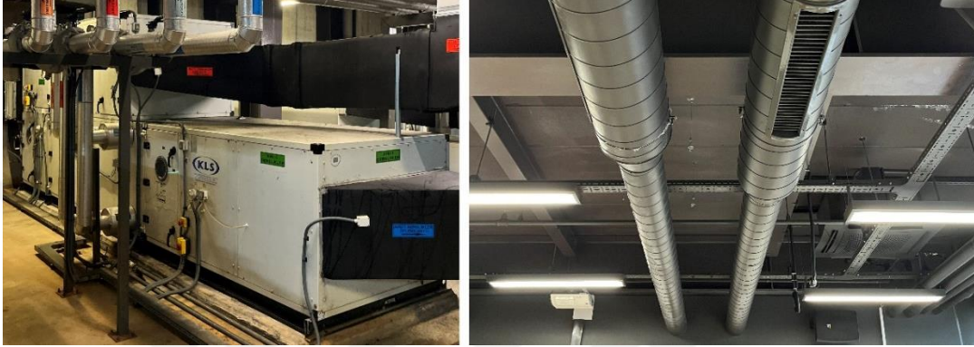
Görsel 4.30. AHU Sistem Elemanları (Kişisel Arşiv)
