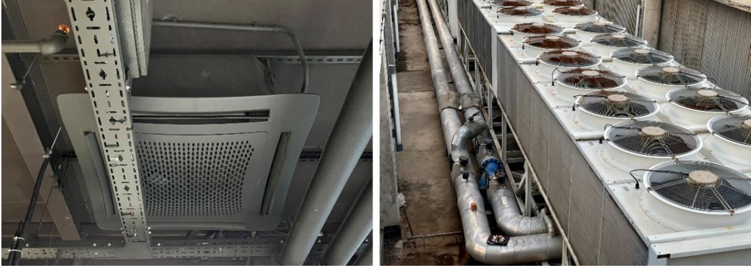
Görsel 4.26. Chiller ve Fancoil Sistem (Kişisel Arşiv)
