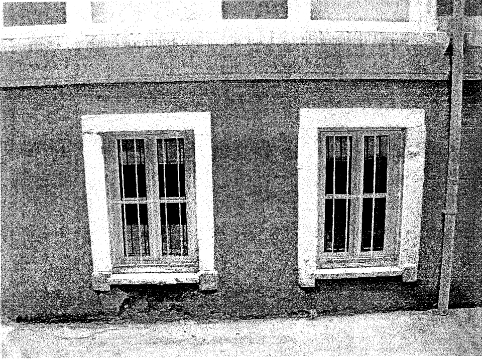
Resim 4.17 Çukur Saray batı cephesinde özgün kalan bodrum kat pencere yan ve üst elemanları (P B-8 ve P B 9' nolu pencereler)
