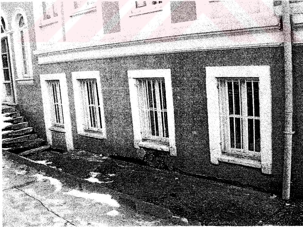
Resim 4.20 Batı cephesinde kat silmesini keserek inen su iniş borusu ve beden duvarındaki yosunlanma
