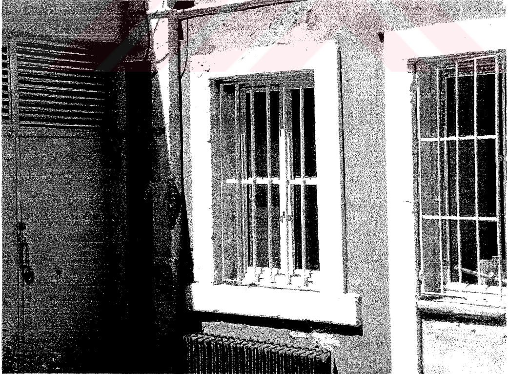
Resim 4.129 Doğu cephesinde boyada görülen dökülmeler
