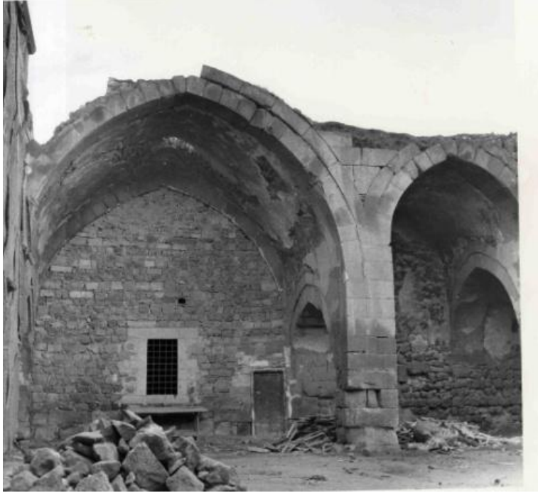
Şekil 93: Medrese, ana eyvan, onarımdan önce (V. G. M. Arş.)
