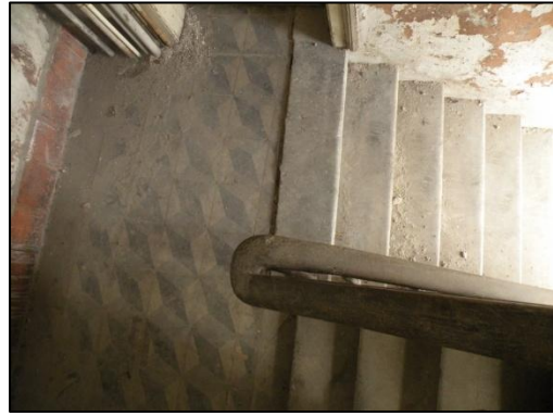
Resim 3.33a. Servis merdiveni ve korkuluğu
