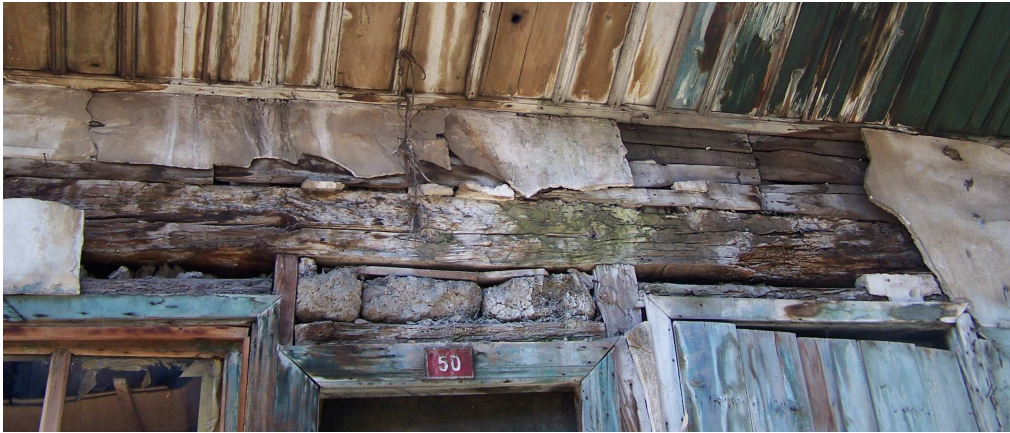
Resim 6.4.130 ada 4 parselde kar ve yağmur sularının aşındırdığı cephe (Seda İnici Arşivi)
