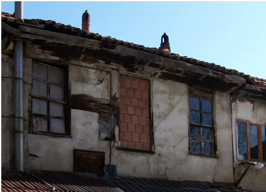
Resim 6.2. 130 Ada sağlam olmayan zeminden kaynaklı oluşan çatlaklar (Seda İnici Arşivi)
