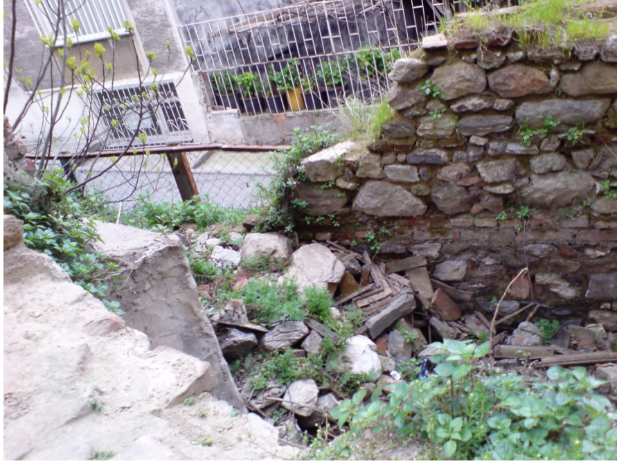
Foto. B.51. Teyyareci Suphi Sokak Üzerindeki Avlu Duvarındaki Tahribat
