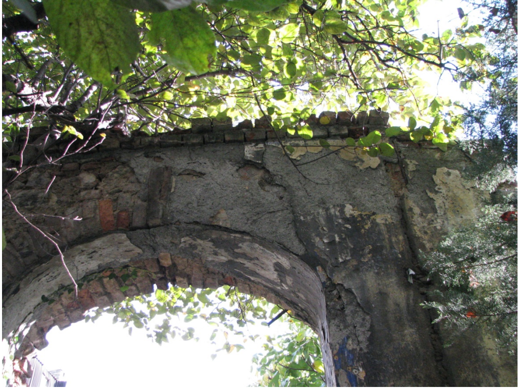
Foto. B.54. Kuzeybatı Cephesi- Yağmur İniş Borusu İzi
