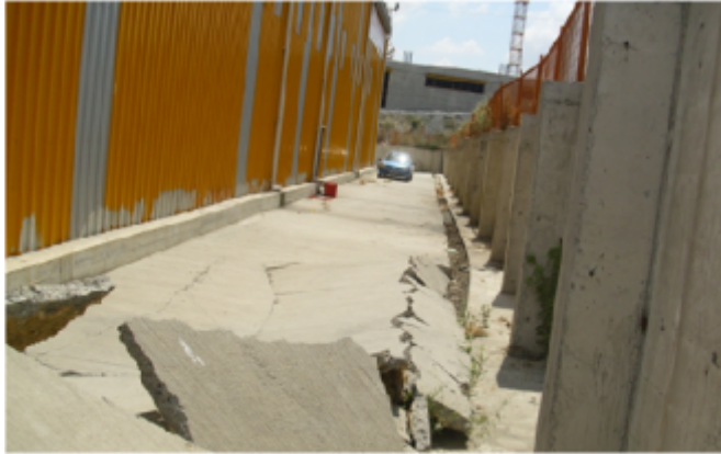
Şekil 4.21: Fabrika binasının hasarları
