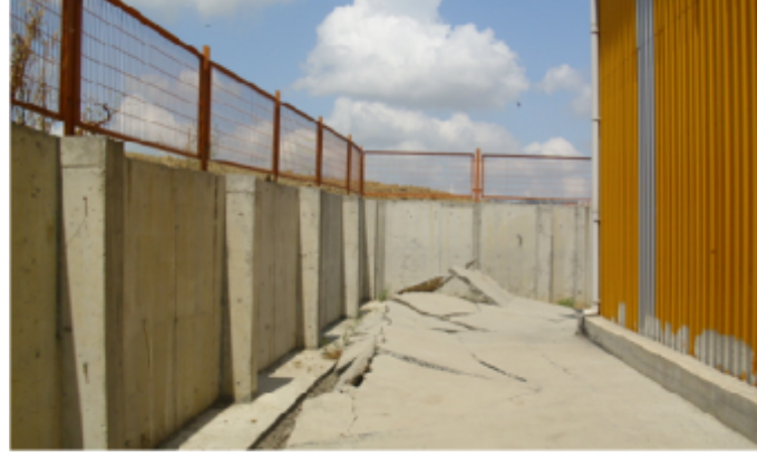
Şekil 4.22: Fabrika binasının hasarları
