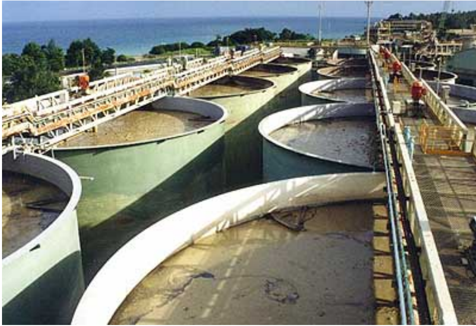
Şekil 2.6. Tesis çapında kullanılan liç tankları.
