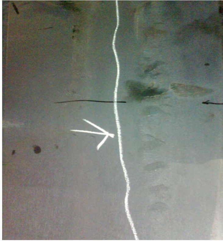
Şekil 6. 17: Malzemedeki enine çatlaklar
