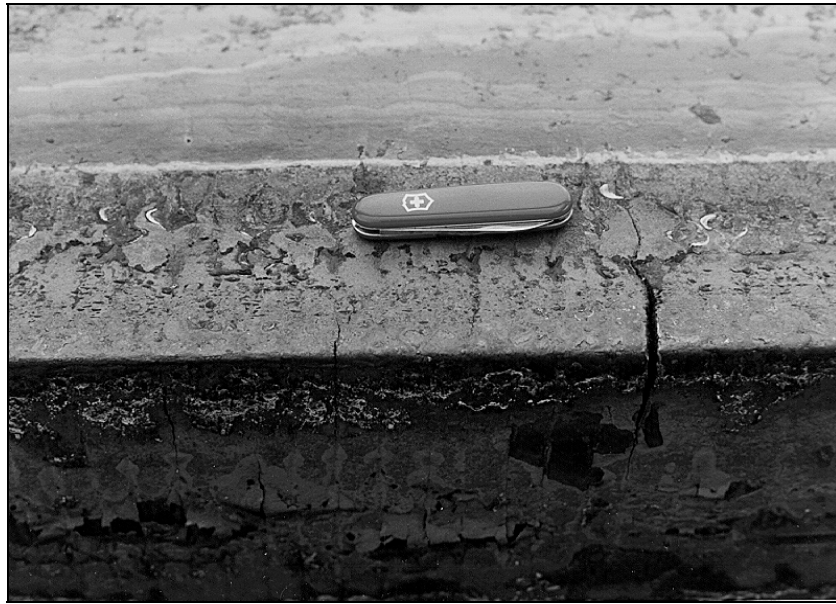
Şekil 6. 5: Slabta köşe çatlağı kusuru [ 22]
