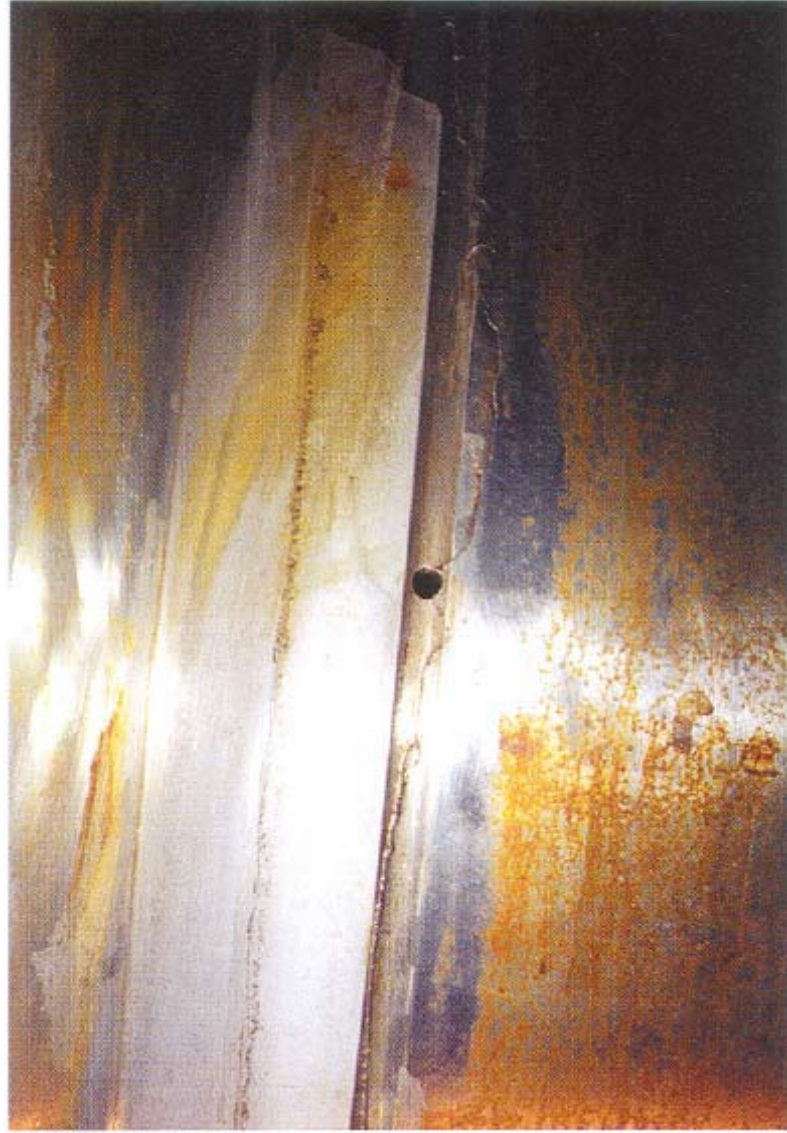
Şekil 11. 23: Merdane muylu yüzeyindeki delik nedeniyle oluşan çevresel çatlak [ 29]
