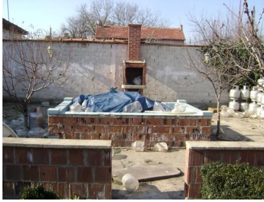
Şekil 5.59. Havuz ve barbekünün bulunduğu bakımsız kısım
