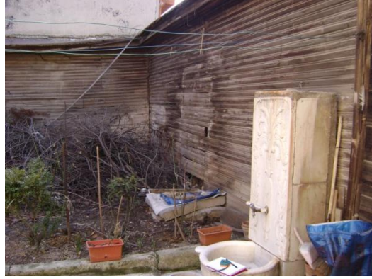
Şekil 5.21. Yıpranmış bahçe duvarı ve bahçenin bakımsız bir köşesi
