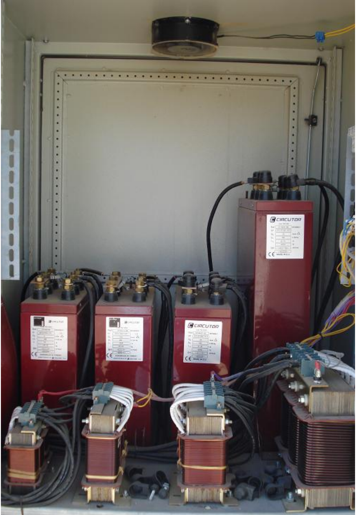
Ek-3 : SVC uygulamasında kullanılan kondansatör grubu
