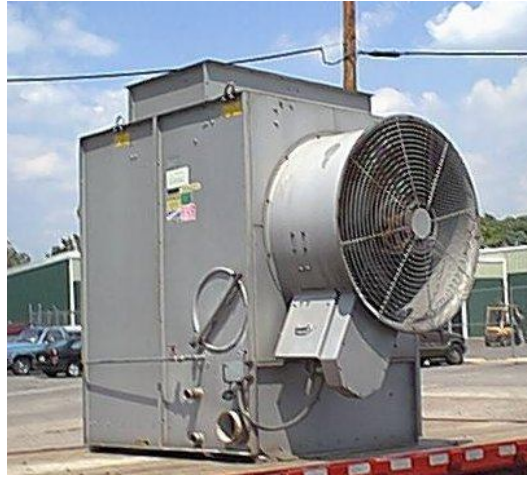
Şekil 3.4.11 Çapraz akışlı soğutma kulesi
