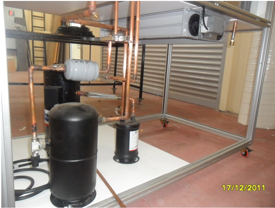
Şekil 6.5 Kompresör ve servis noktaları
