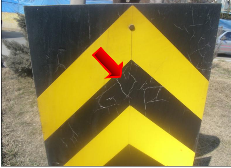
Resim 6.28. Güneş etkisiyle görünürliğini yitirmiş reflektif malzeme ile kaplı olmayan trafik levhası [Dilek, 2010]
