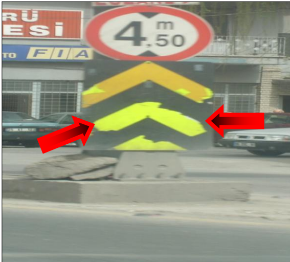
Resim 6.27. Reflektif malzeme kullanılmamış ve mevcut kaplaması sökülmüş trafik levhası [Dilek, 2010]
