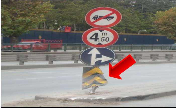
Resim 6.38. Standartlara uygun olarak montajı yapılmadığı için tehlike yaratan trafik levhası (3) [Dilek, 2010]
