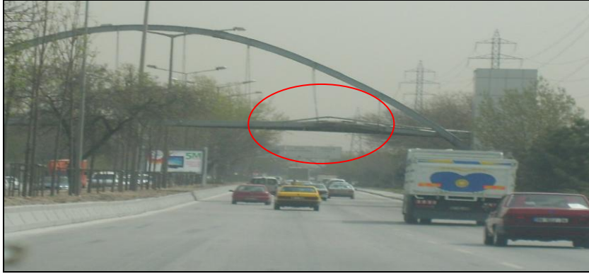
Resim 6.59. Düşey işaretleme yapılmamış bir üst geçitte oluşan kaza sonrası oluşan hasar (İstanbul Yolu) [Dilek, 2010]
