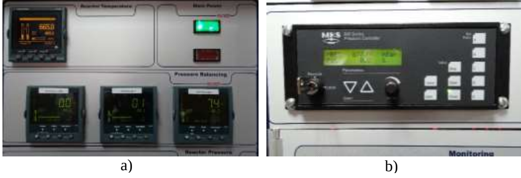
Şekil 3.3 Sıcaklık kontrolörü (üst) ve Eurotherm basınç farkı kontrolcüsü (alt) (a), reaktör basıncı kontrolcüsü (b).
