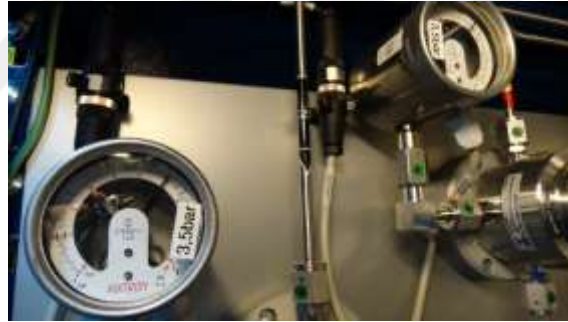
Şekil 3.14 Reaktöre giren azot ve hidrojen ana hatlarının basınç göstergeleri.
