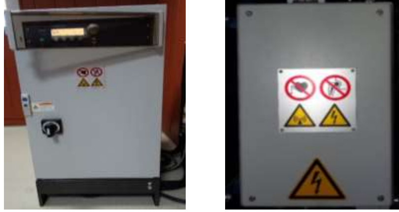
Şekil 3.24 RF jeneratörü ve osilatör ünitesi.
