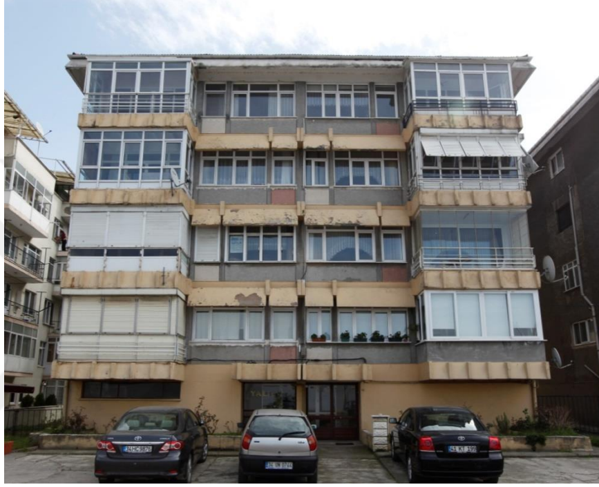
Şekil 5.37. Yüzbaşılar Mahallesi'nde kısa kolon yapısal risk unsuru barındıran yapı örneği
