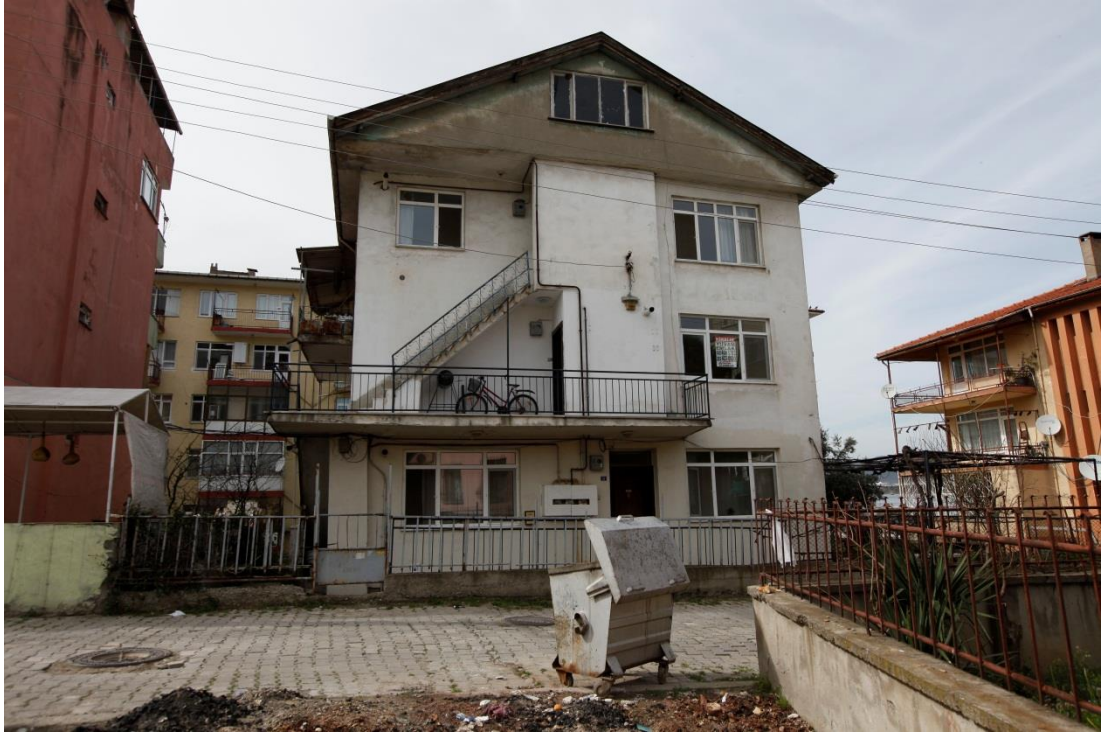
Şekil 5.42. Yüzbaşılar Mahallesi’nde çıkma kat yapısal risk unsuru barındıran yapı örneğı
