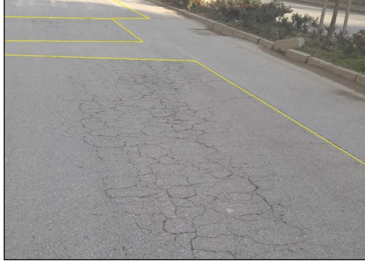
Şekil 4.11: Aydınlatma hattı nedeniyle oluşan bozulma
