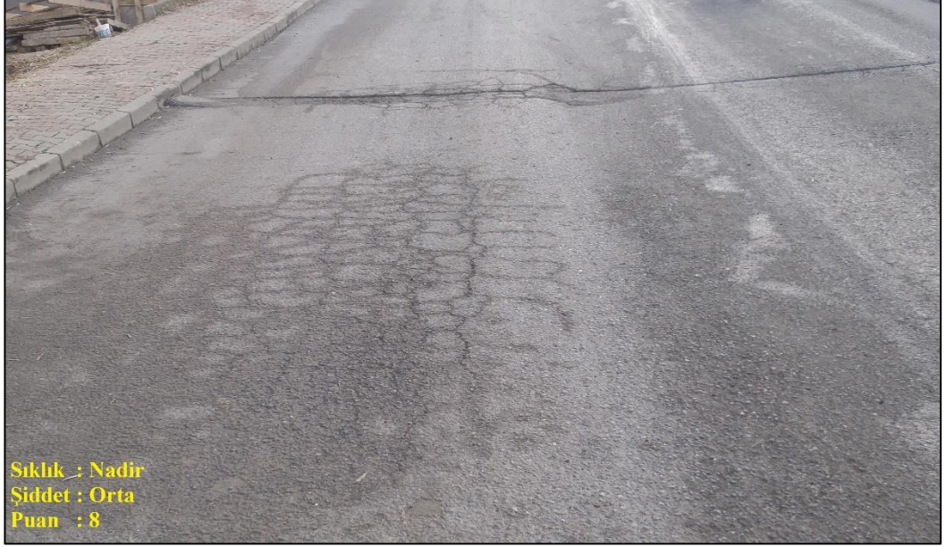
Şekil 4.21: Uğur Mumcu Caddesi yol bozulma endeksi
