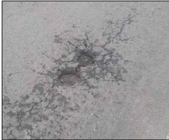
Şekil 4.10: Karot alınması sonucu oluşan bozulma
