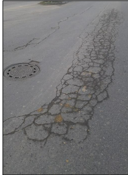
Şekil 4.12: Altyapı çalışması sonrası oluşan bozulma
