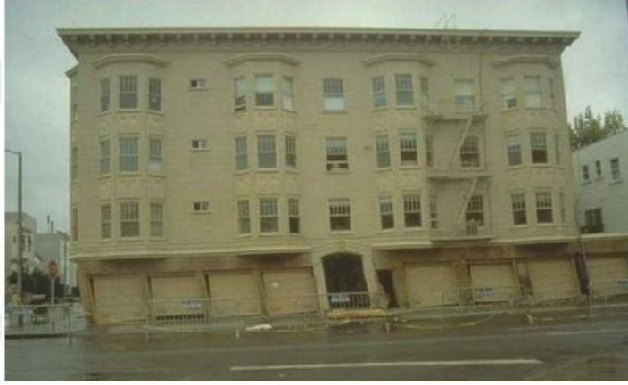
Şekil 1.13 : Çok üniteli ahşap bir yapıda yumuşak kat hasarı (CU, Berkeley).
